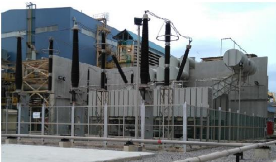
Figure II-12 : Transformateur principal élévateur [5].
