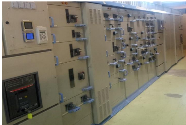
Figure IV-3 : Salle technique (SKT).
