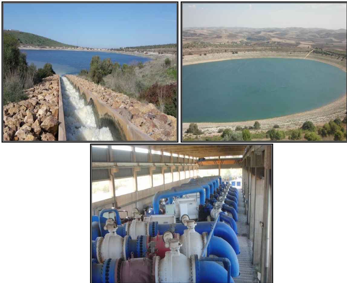
Figure II.5 : La station de traitement Dzioua [10]
