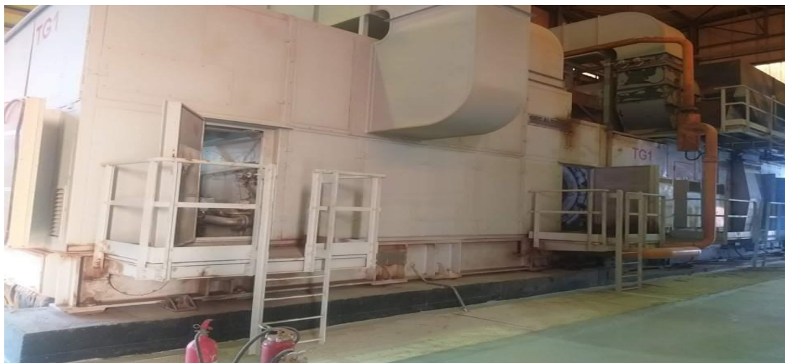
Figure VII.65: Générateur Electrique turbine à gaz
