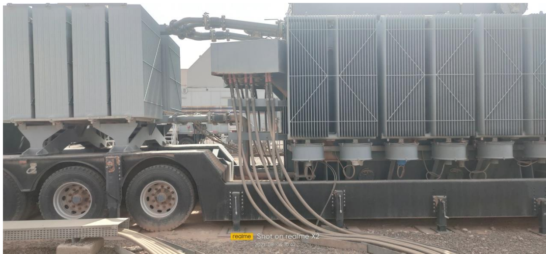
Figure VII.64 : Générateur Electrique mobile
