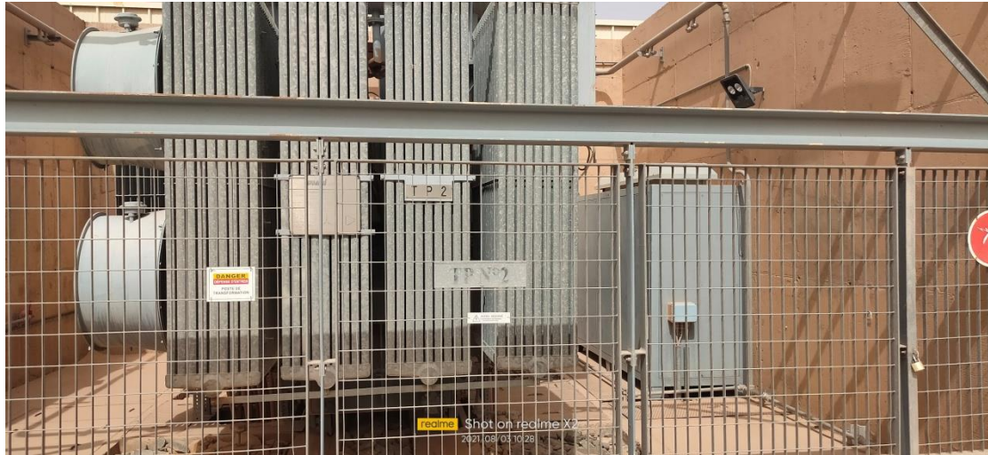
Figure VII.66 : Transformateur de Puissance
