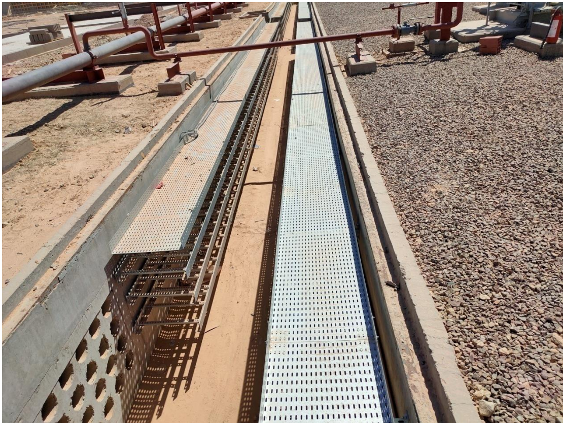
Figure VII.73 : Chemins de câble
