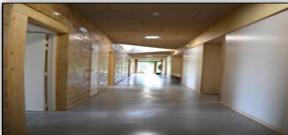
Figure 33: éclairage par interrupteur crépusculaire et détecteur de présence
