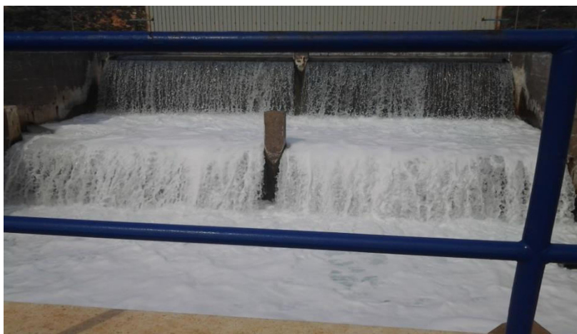
Photo 13 : Bassin de saumure. [BWC]
