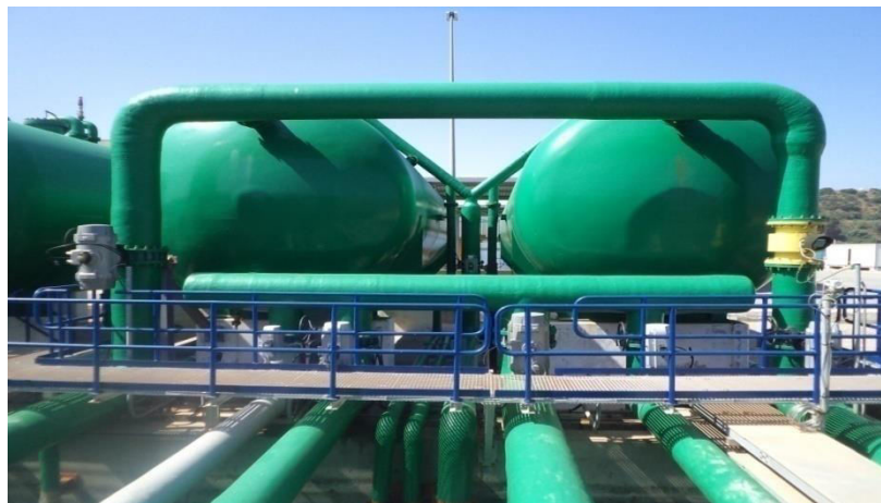
Photo 04 : Module de filtre à sable. [BWC]
