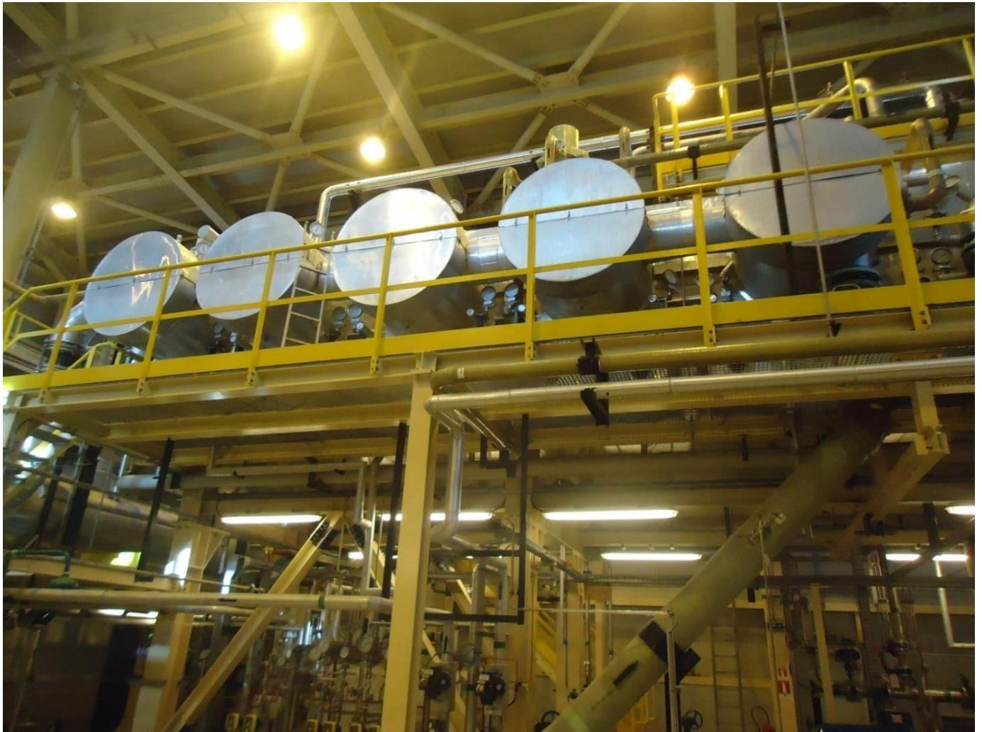
Photo15 : unité de station de dessalement. [SKT]
