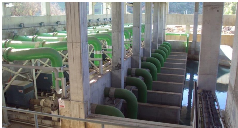
Photo03 : pompes de pompage et bassin de stockage. [BWC]
