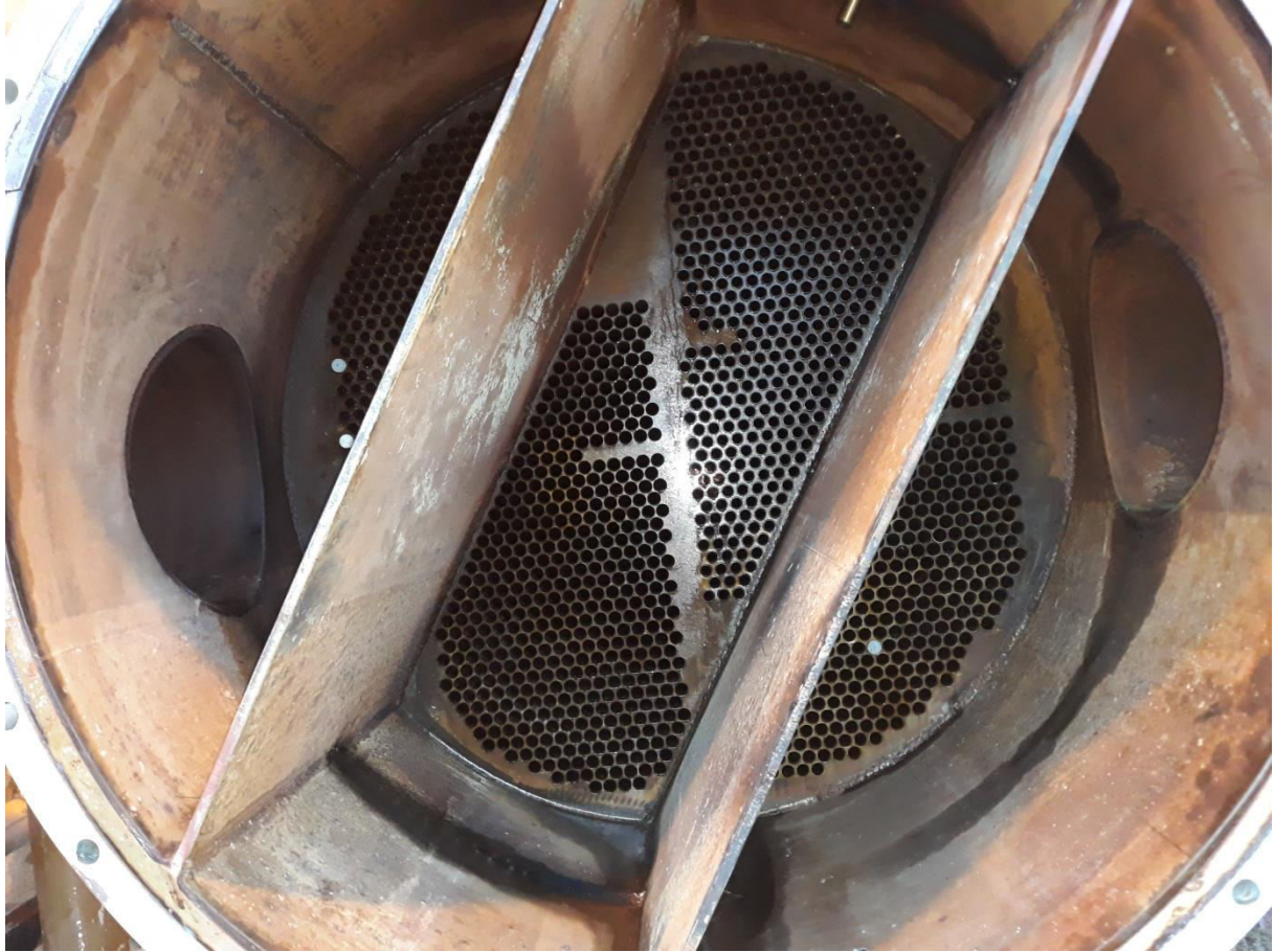
Photo 16 : chambre flash de dessalement. [SKT]
