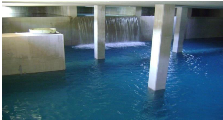
Photo 12 : Bâtiment d'eau produite. [BWC]
