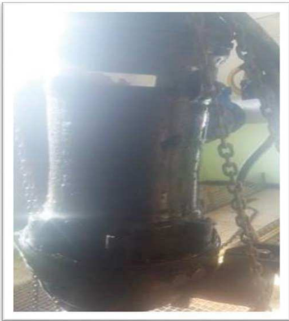
Figure IV: la pompe de relevage
