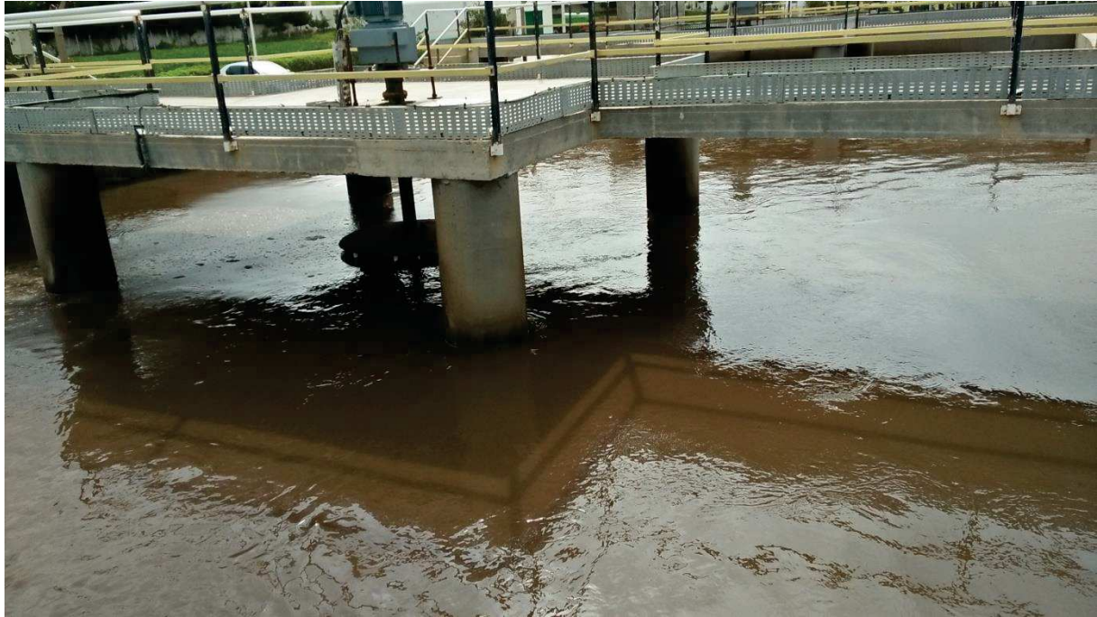
Figure X : Bassin de contact
