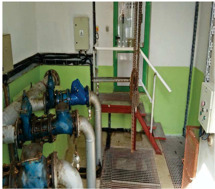
Figure V: Chambre de vannes
