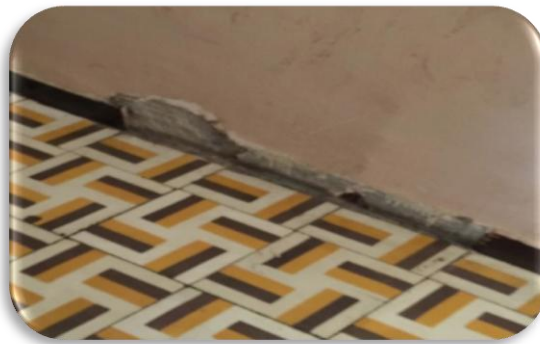
Photo n° 4.22 Manque des plinthes
