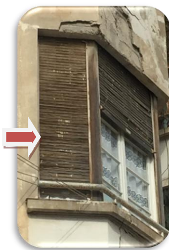
Photo n° 4.13 Dégradation des fenêtres
