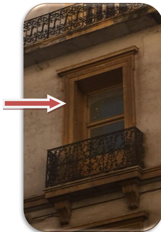
Photo n° 4. 67 : Manque de persienne d'une fenêtre
