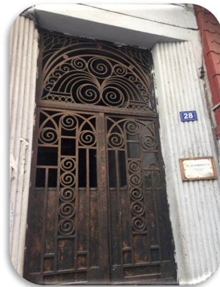
Photo n° 4. 44 Dégradation de la porte d'entrée et manque de vitrage
