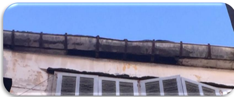
Photo n° 4. 83 : Dégradation des chéneaux
