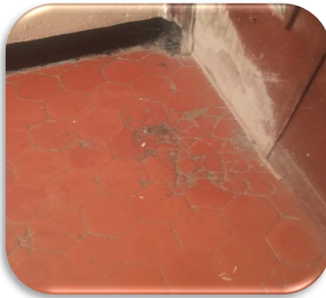
Photo n° 4. 75 : Dégradation de revêtement de sol de paliers intermédiaires
