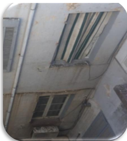
Photo n° 4. 88 : Manque des persiennes de quelques fenêtres
