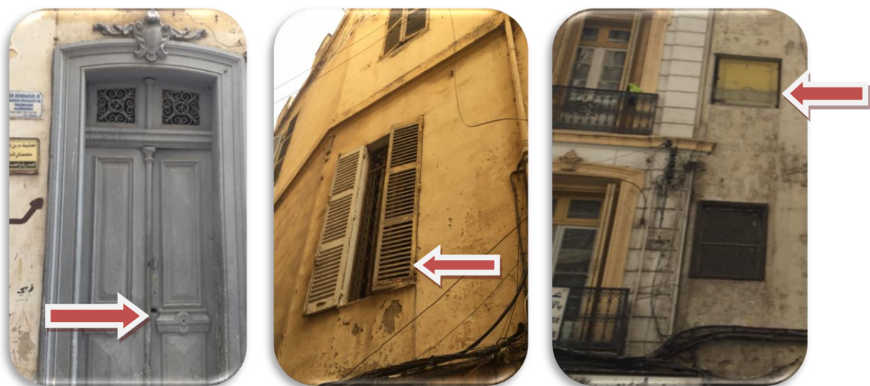
Photo n° 4. 4 : dégradation des éléments de menuiserie
