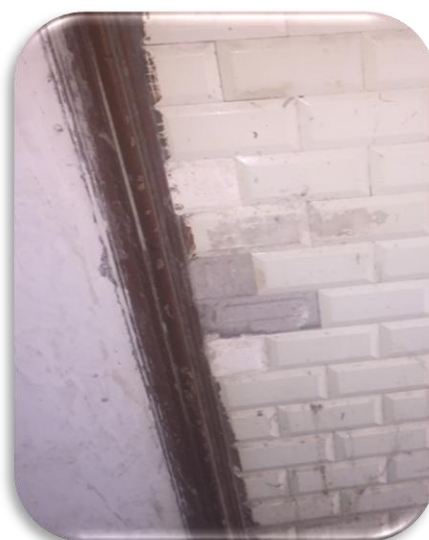
Photo n° 4. 74 : Manque quelques pièces de revêtement de mural de soubassement au niveau hall
