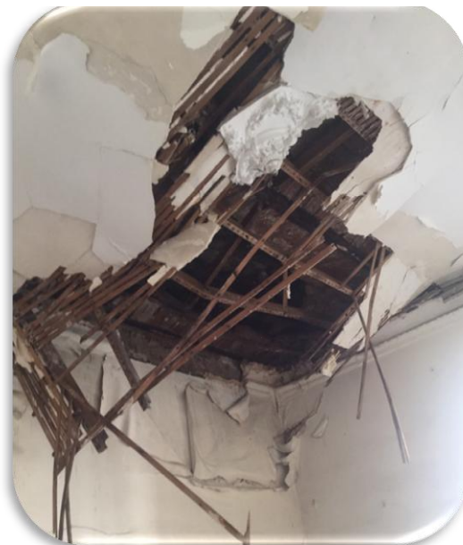
Photo n° 4. 78 : Effondrement des parties de plafond (le dernier étage) et Corrosion des profilés
