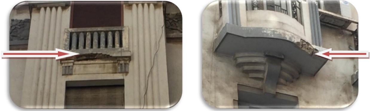
Photo n° 4. 42 Dégradation des corniches des balcons
