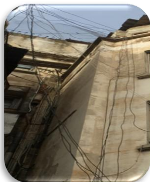
Photo n° 4.8: La mauvaise installation des câbles du réseau électrique
