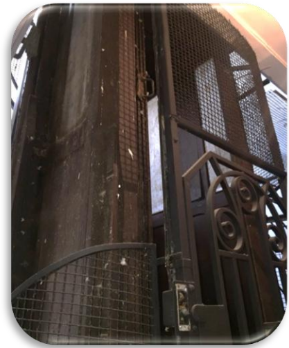
Photo n° 4. 49 Ascenseur en panne
