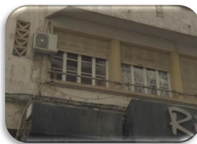
Photo n° 4.9 les climatiseurs ont mal positionnées par les propriétaires
