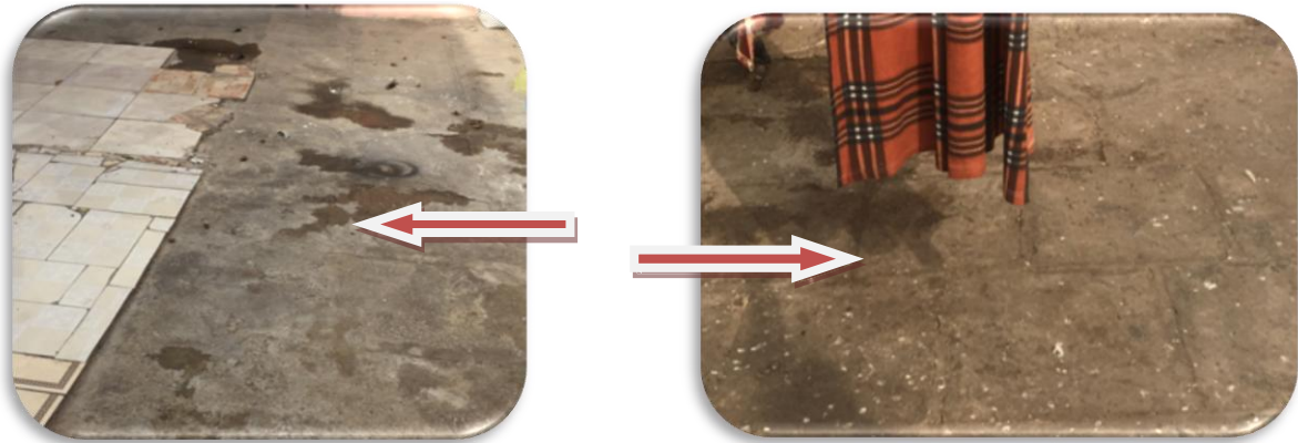
Photo n° 4.29 Détérioration de revêtement de sol de la terrasse coté gauche et droit
