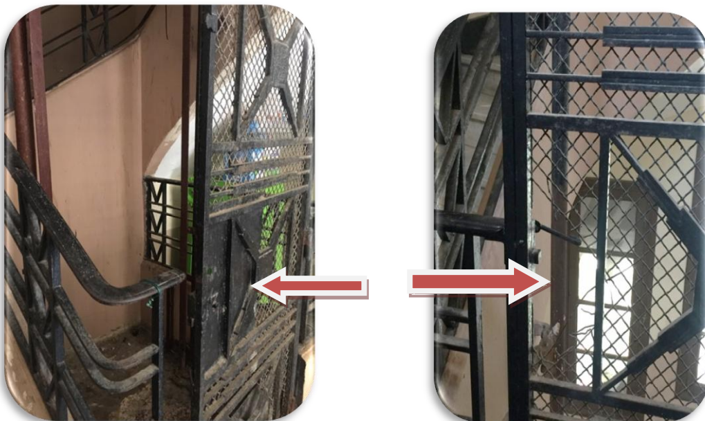
Photo n° 4.21 une ascenseur en panne et déchirement de quelques parties de grille
