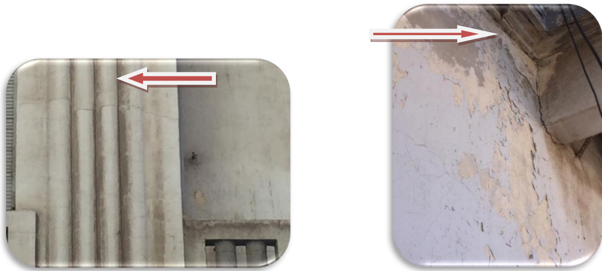
Photo n° 4. 37 Dégradation de la peinture extérieure et présence des fissures
