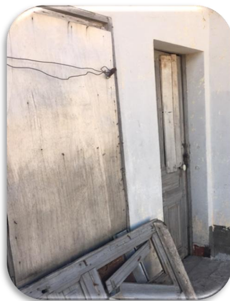
Photo n° 4. 54 Dégradation des éléments de menuiserie
