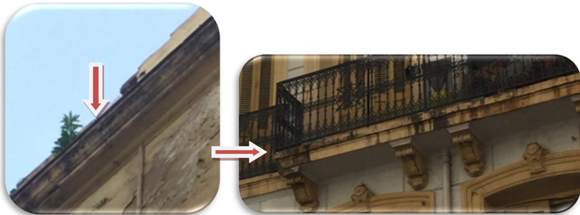
Photo n° 4.5 : dégradation des éléments de menuiserie
