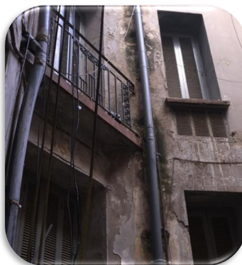
Photo n° 4. 58 Dégradation la tuyauterie de la décente d'eau pluviale
