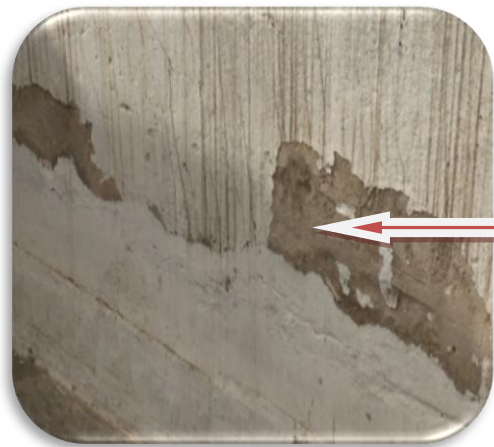
Photo n° 4.33 Ecaillage de la peinture des murs
