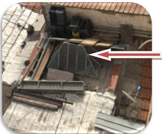
Photo n° 4.27 Verrière 1 couvert le plafond de la cage d'escalier avec des cassures de vitre
