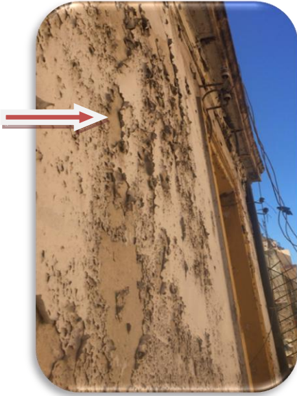
Photo n° 4. 60 : Dégradation de la peinture extérieure et présence des fissures
