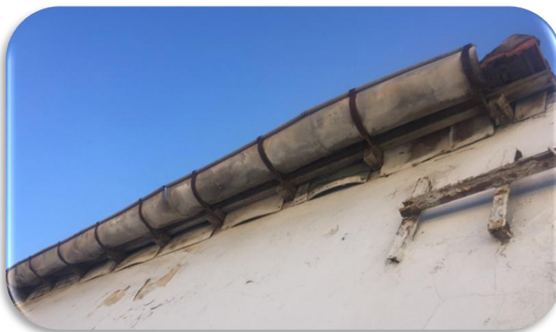
Photo n° 4. 80 : Dégradation de chéneau
