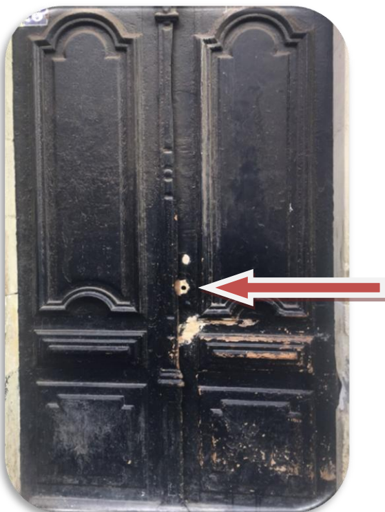
Photo n° 4. 66 : Dégradation de la porte d'entrée
