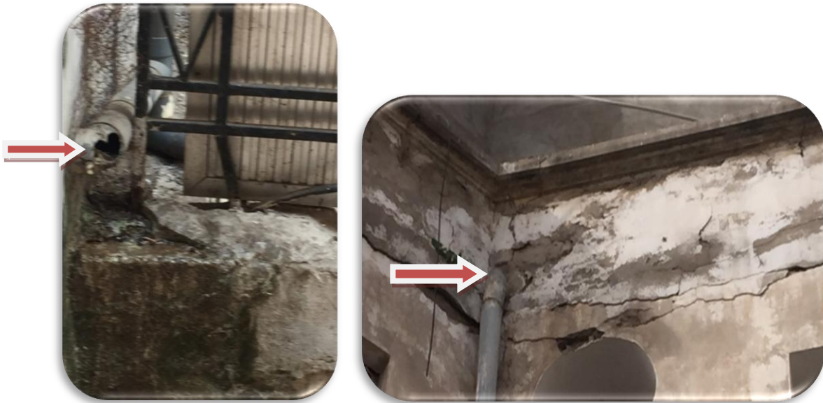
Photo n° 4.11 Des cassures au niveau de la partie inférieure de tuyau
