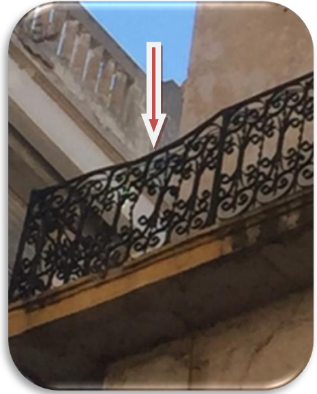
Photo n° 4. 61 : Déformation une partie de garde corps de balcon
