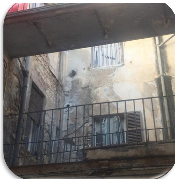
Photo n° 4. 85 : Dégradation de la passerelle
