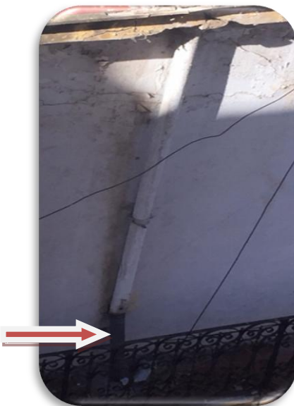
Photo n° 4. 63 : Dégradation de la tuyauterie de la décente d'eau pluviale
