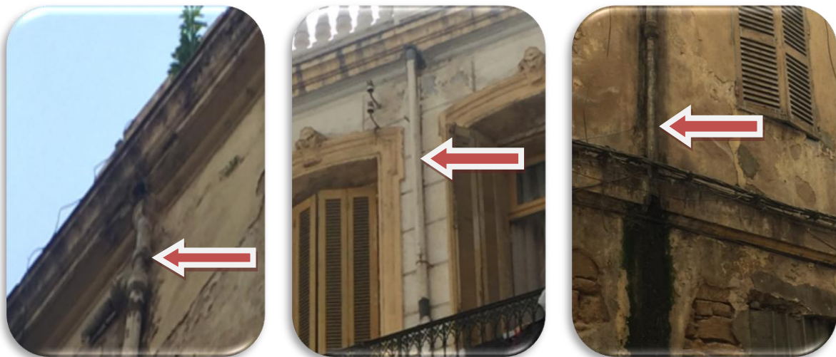
Photo n° 4.2 : Dégradation Tuyau de descente d'eaux pluviales source: Auteur
