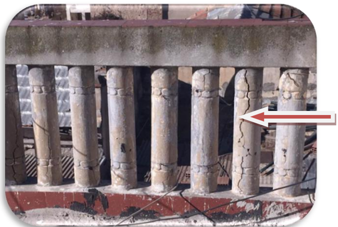
Photo n° 4. 52 Balustrades en pierre fissurés
