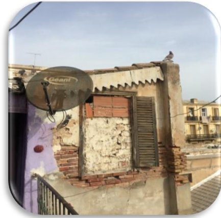
Photo n° 4.25 Toit en tuile remplacé par une tôle à cause des infiltration d'eau
