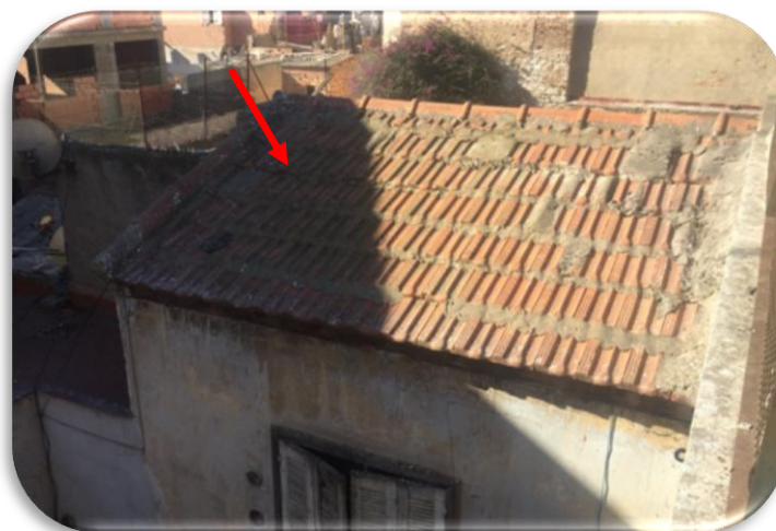
Photo n° 4. 81 : Dégradation de couverture en tuile
