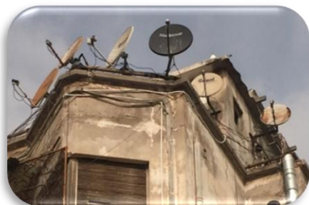
Photo n° 4.7: le parabole est mal positionnée
