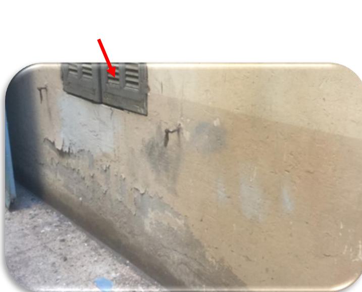
Photo n° 4. 84 : Dégradation de la peinture extérieure et présence des fissure
