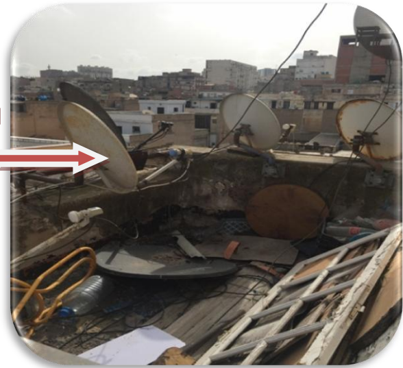
Photo n° 4.31 Pose des paraboles qui défigure l'aspect de la terrasse
