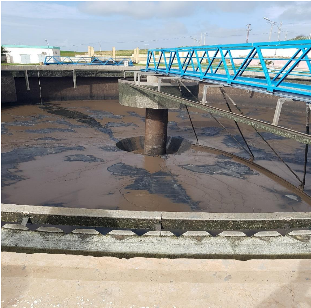
Figure IV.4 : Bassin de décantation vide (STEP Ain Témouchent le 06/03/2018).
