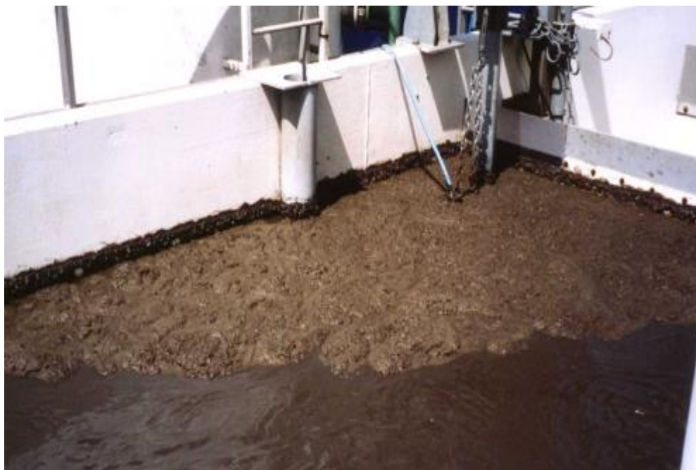
Figure IV.2 : Présence de mousse à la surface du bassin d'aération [9].
