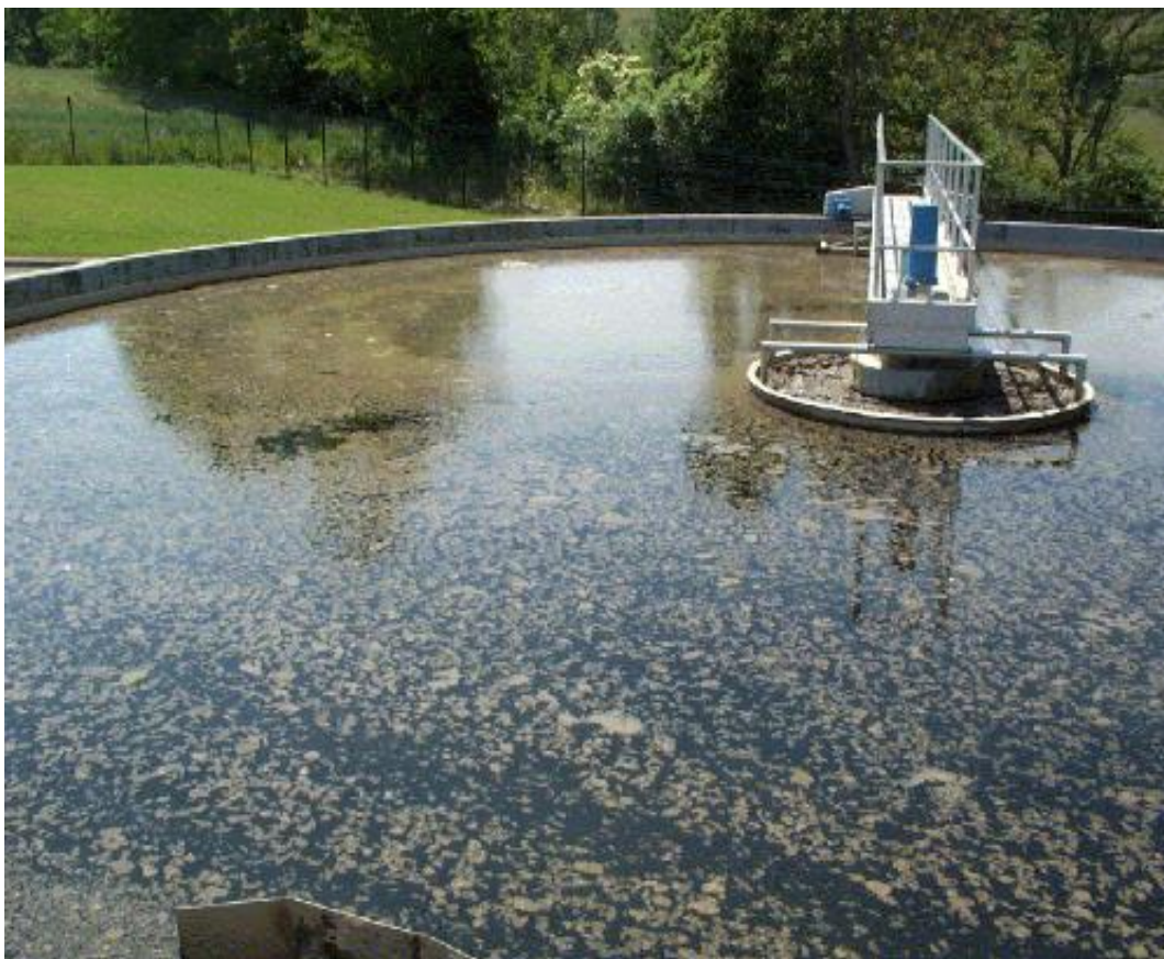
Figure IV.3 : Boue remontée à la surface du clarificateur [9].
