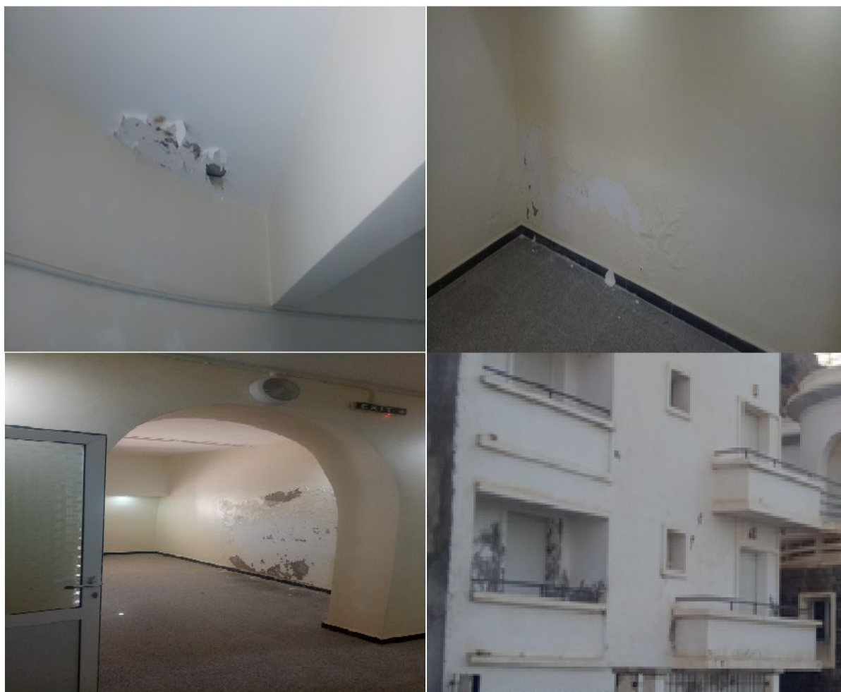
Figure I.61 : Dégradation de l'enduit dans les murs.
