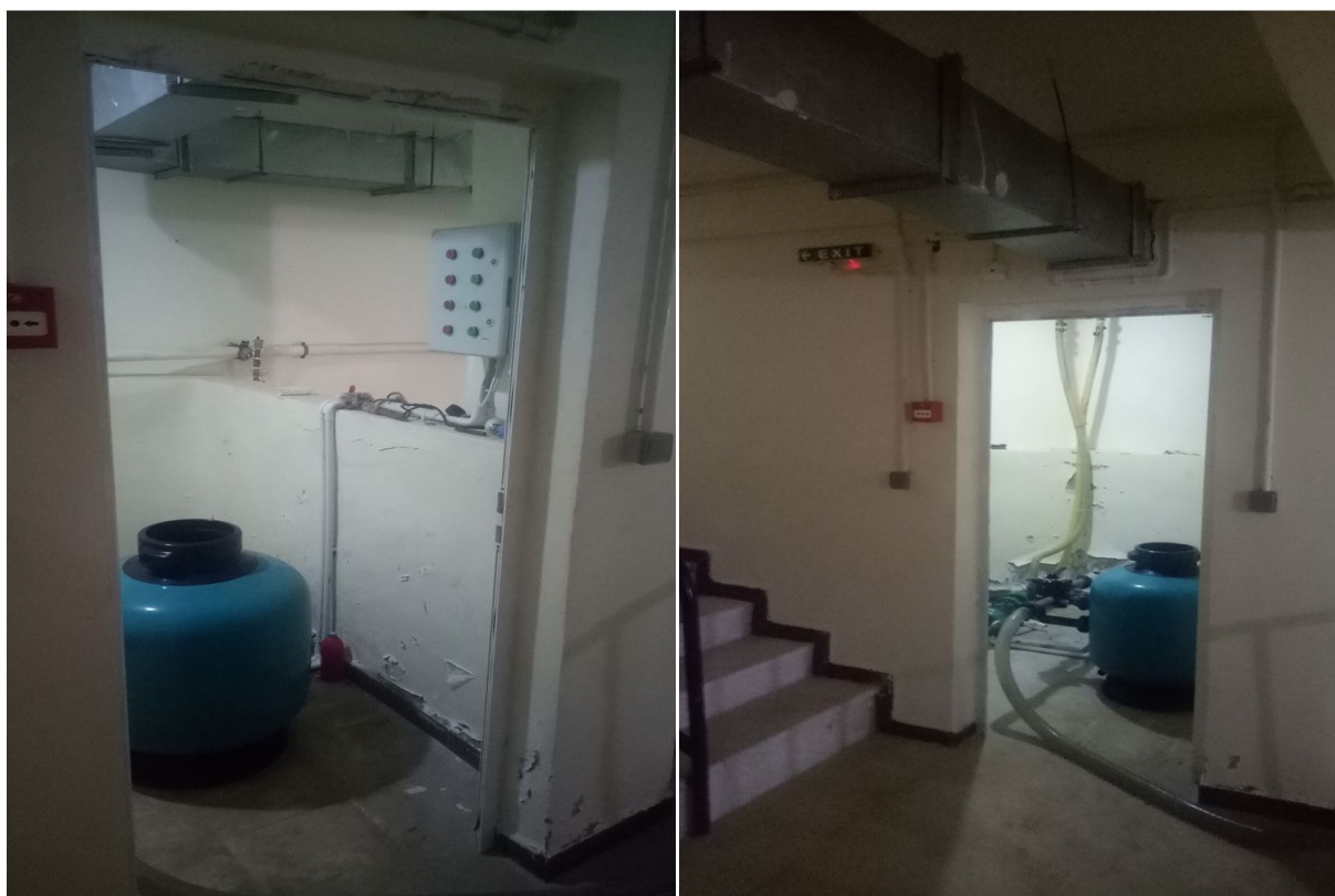
Figure I.52 : Salle de machine.
