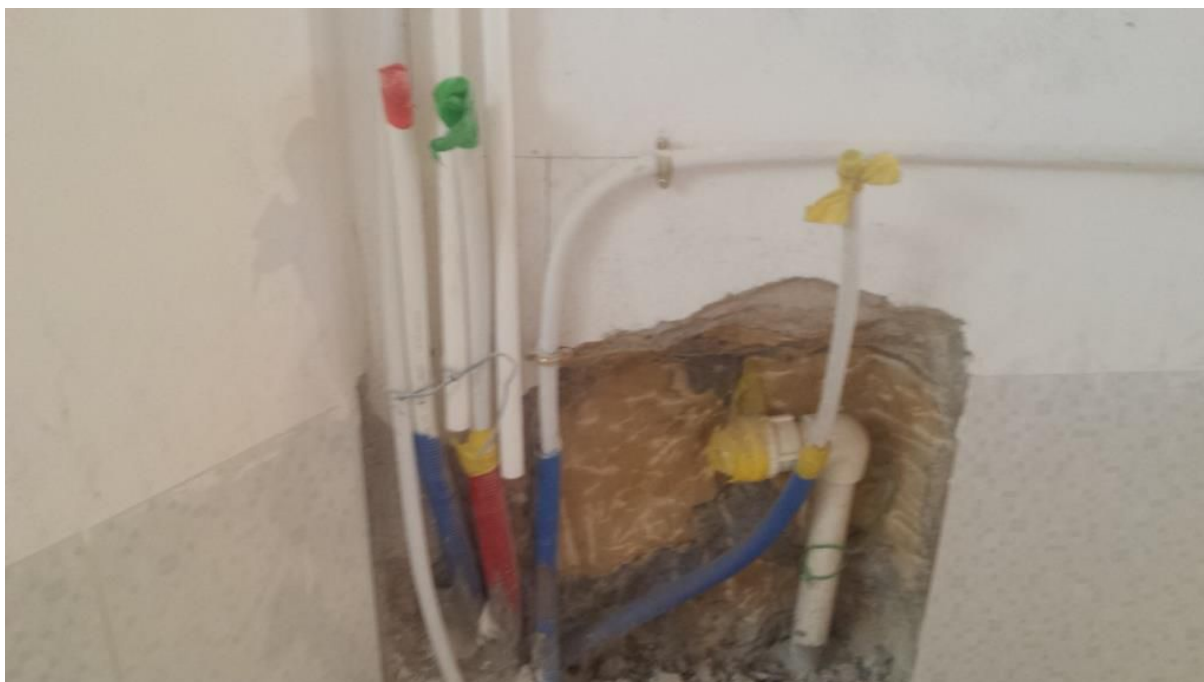
Figure I.41 :Les divers réseaux de tuyauteries
