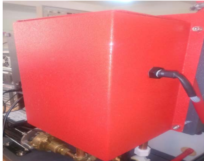
Figure 3.10 : Réservoir d'eau chaude
