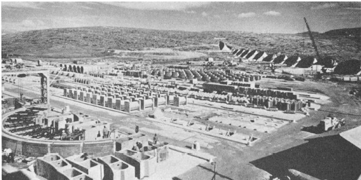
Image 3.5 Vue d'ensemble du chantier de préfabrication, situé immédiatement en aval du barrage. Au premier plan, les éléments de voûtes, à l'arrière-plan, le stockage des blocs des contreforts. A droite, dans l'ombre, la fabrique de béton.
