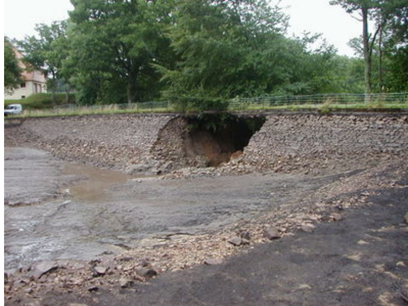
Figure 12 :Exemple de brèche suite à érosion interne.
