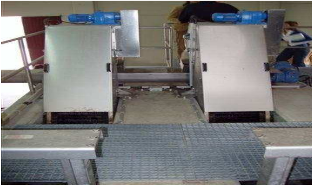
Figure N°3 : Grilles mécanisée fines
