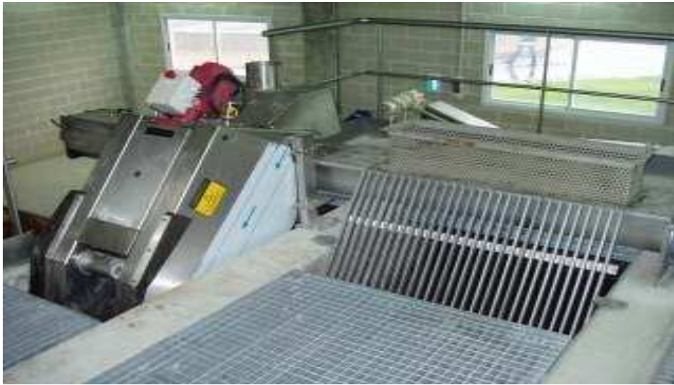
Figure N° 2 : Grille mécanisée grossière
