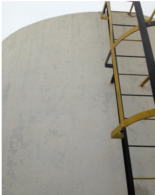
Figure 18 :Cuve de neutralisation
