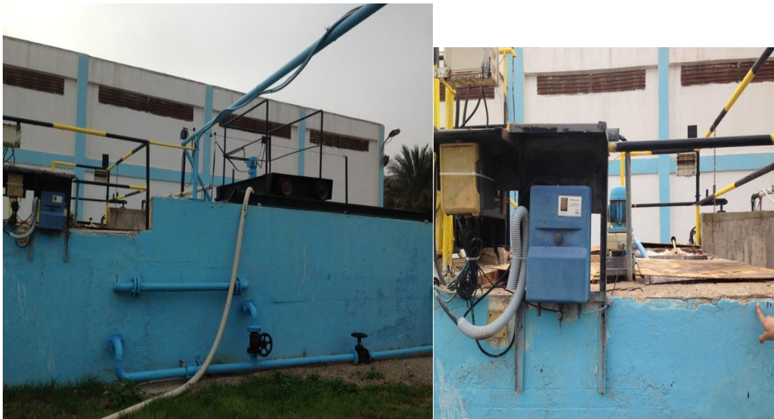
Figure 11 : Chambre des pompes
