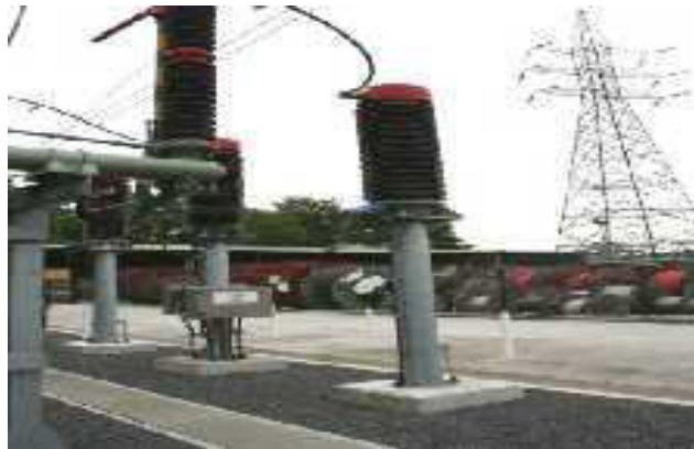
Fig (I.5) : Transformateur de tension
