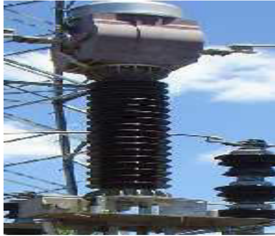
Fig (I.4) : Transformateur de courant
