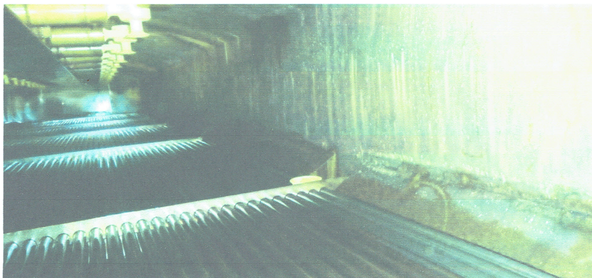
Figure II.13 : La cellule d'évaporation de l'unité de dessalement U .510
