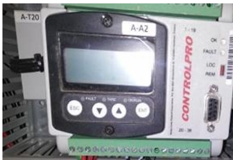
Figure III.13 : Unité de contrôle
