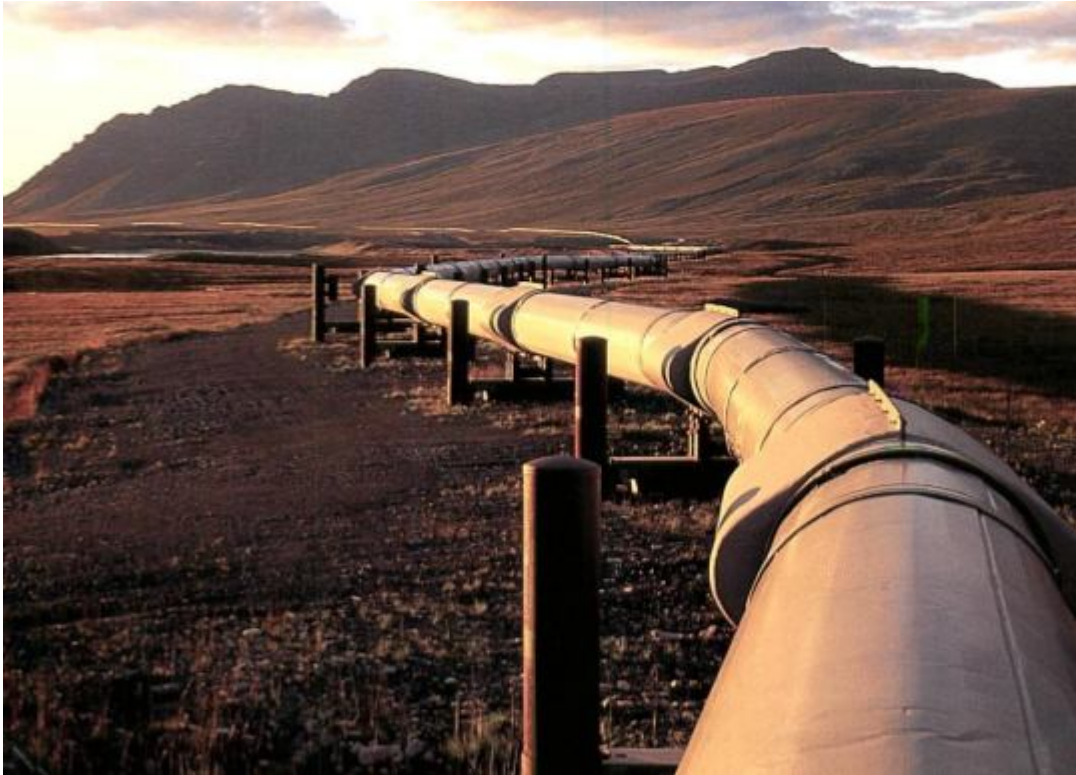
Figure I.1 : Pipeline pour le transport de pétrole [3]
