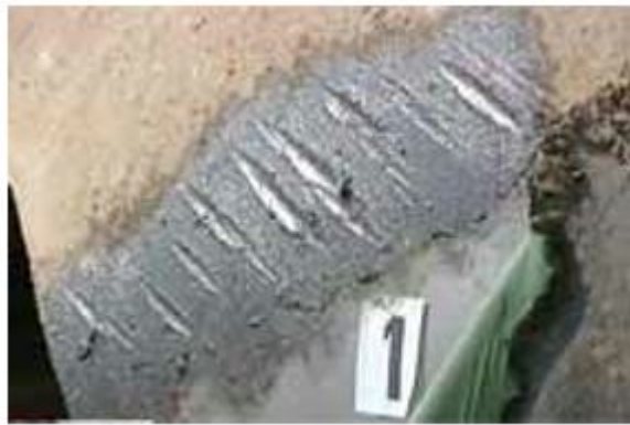
Figure II.10 : Défaut de type éraflure. [16]
