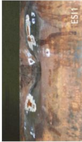
Figure II.11 : Défaut de type enfoncement. [16]
