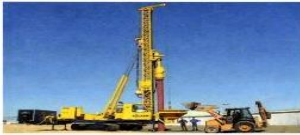
Figure III.10: l'atelier de colonnes ballastées voie sèche (Construction d'une Fromagerie BEL à Kolea).
