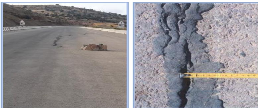
Figure III. 12 Localisation des fissures dans la chaussée côté gauche.
