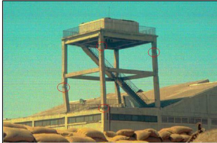
Figure 7.9. Endommagement d'un portique deux étages par flexion dans les zones critiques des poteaux dans une installation portuaire lors du séisme de Buhj (Inde) en 2001.
