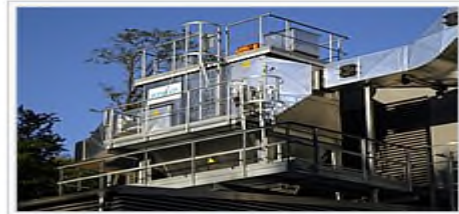
Figure (03) : Les filtres électrostatiques
