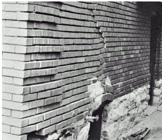
Figure I.1 : Rupture fragile d'une structure maçonnée [1].
