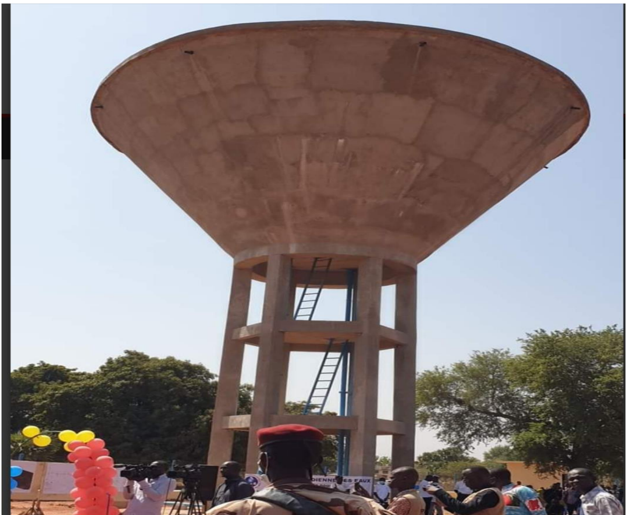
Figure N° (I.3) : Actuel château d'eau 500 m 3 de Koumra (Source STE, 2024).
