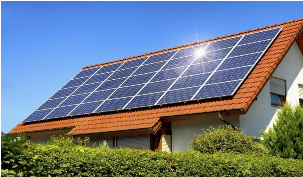
Figure I.1 : panneaux des énergies solaires
