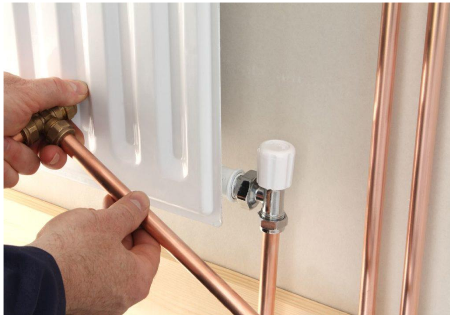
Figure 40: Installation en tube de cuivre
