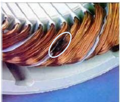
Au niveau des têtes de bobines
