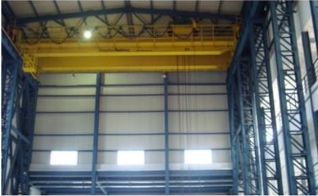
Figure 2.21 : Vue sur le pont roulant du laboratoire du CGS. [37]
