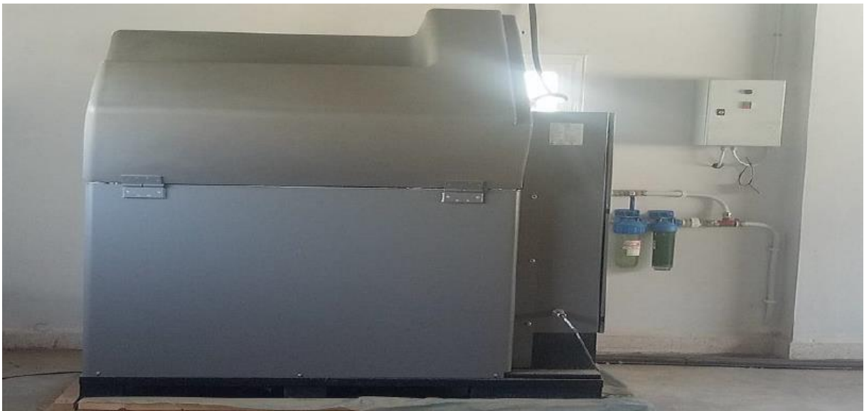
Figure 2.30 : Centrale hydraulique (HPU) de la table de RISAM.
