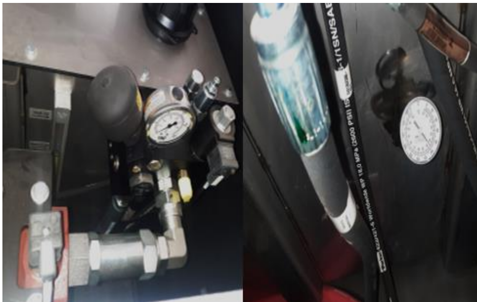
Figure 2.31 : Vue intérieure de HPU.
