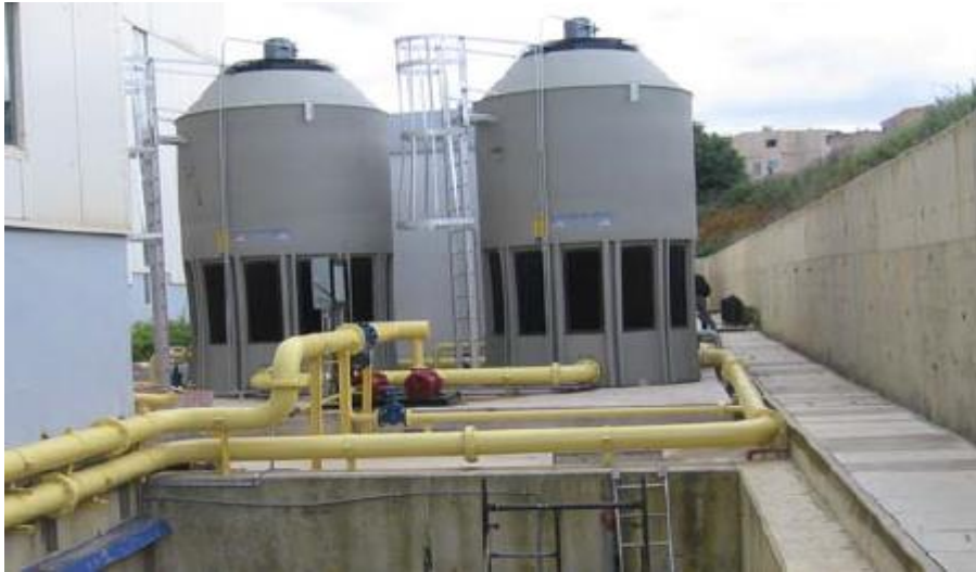
Figure 2.20 : Vue de l'alimentation hydraulique et des systèmes de refroidissement. (a) Pompes hydrauliques, (b) Réservoir d'huile et système de refroidissement d'huile, (c) Tours du système de refroidissement à l'eau [36].
