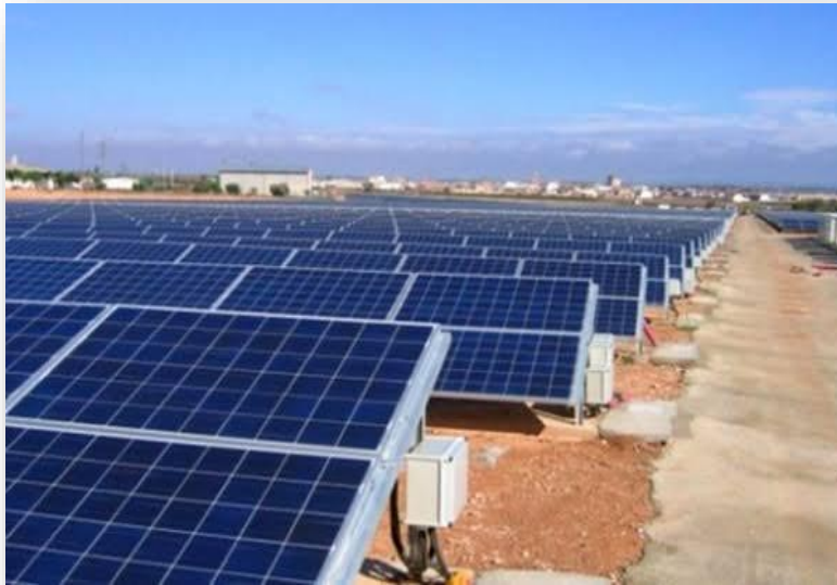
Fig. I. 5: Central solaire photovoltaïque.
