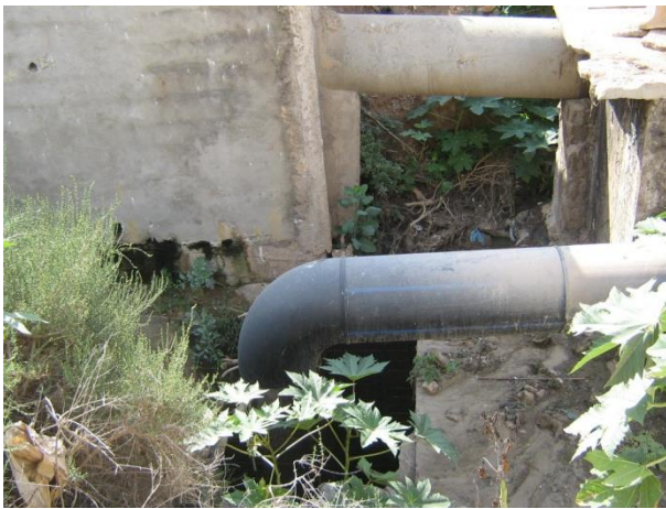
Figure N°V.2 : Point de rejet de la conduite de refoulement (DRE)
