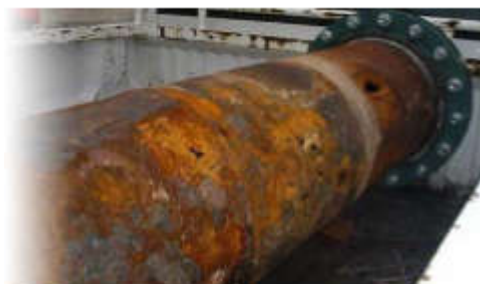
Figure I.15 : Corrosion externe dans la pipe
