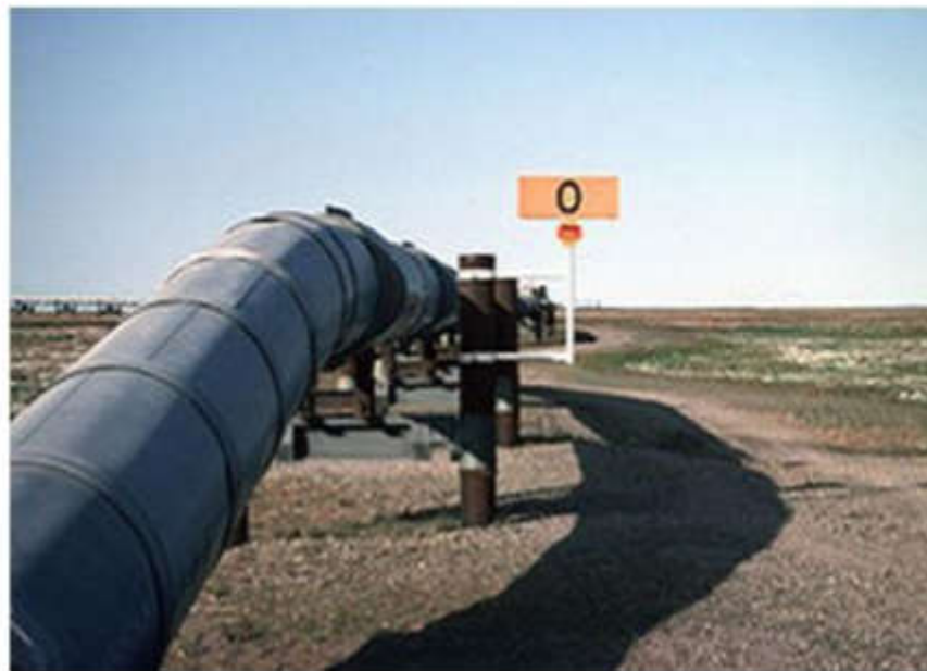
Figure I.8 : Pipeline dans l'environnement [5]
