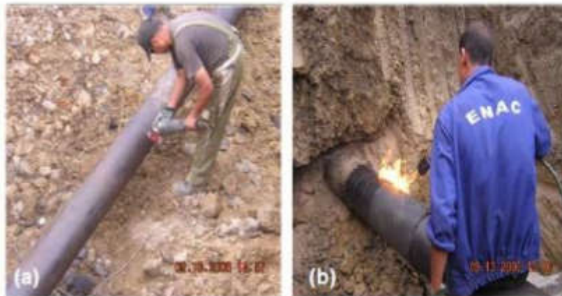
Figure II.9 : (a) réparation de surface pour réfection enrobage, (b) fuite de bentalha (oran, algerie) [26]
