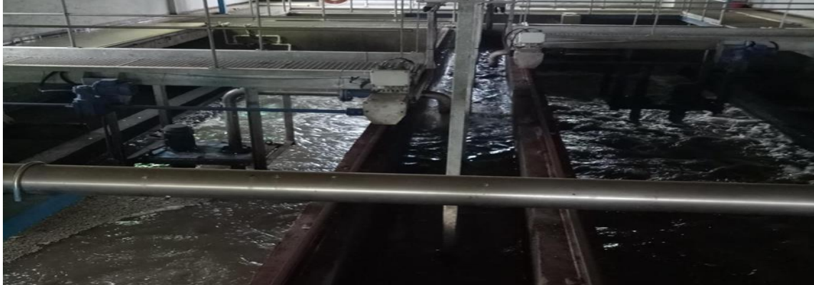
Figure 11 Les deux déssableurs-déshuileurs
