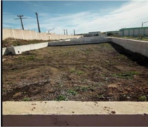
Figure 14 Lit de séchage
