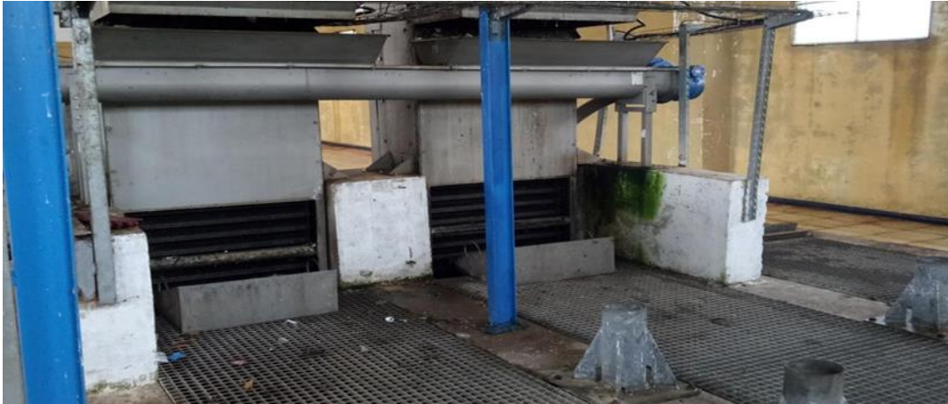
Figure 10 Les grilles fines motorisées.
