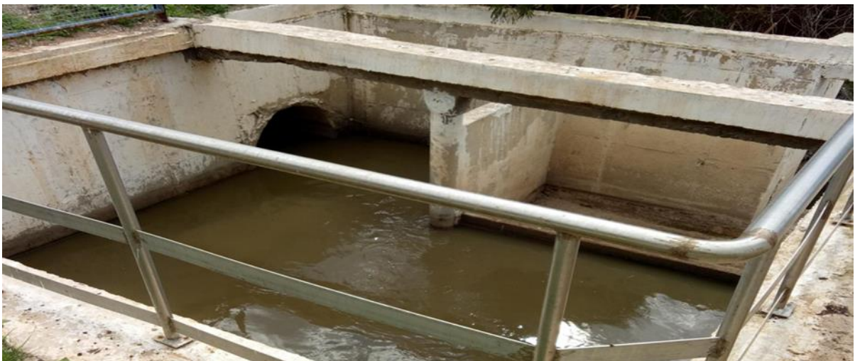
Figure 8 Le déversoir d'orage.
