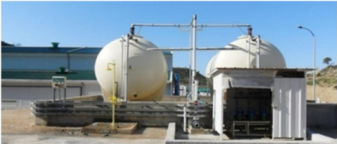
Fig. II.28. Réservoir d'Hypochlorite de sodium. [05]
