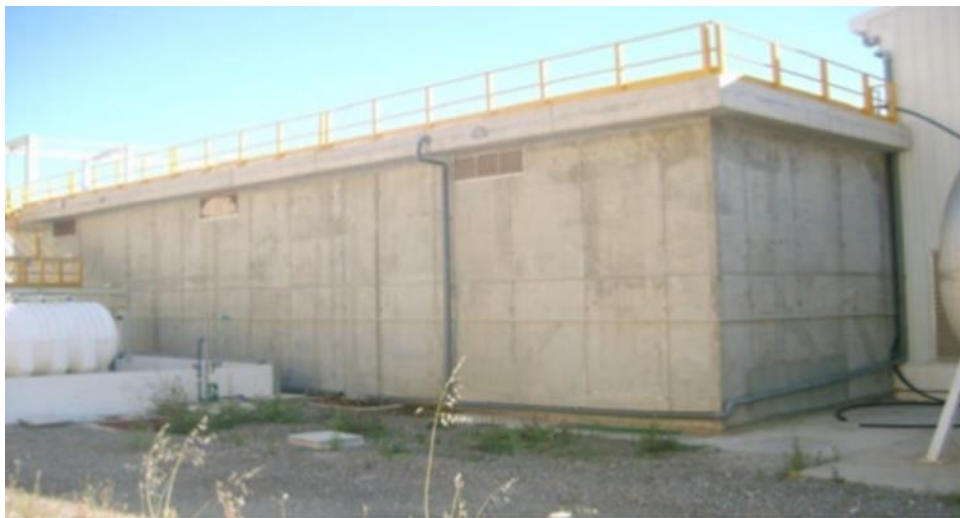
Fig. II.29. Réservoir d'eau produit. [05]
