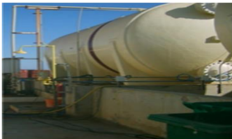
Fig. II.14. Réservoirs de chlorure ferrique.[05]
