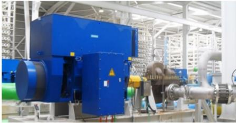
Fig. II.22. Pompe à haute pression. [05]
