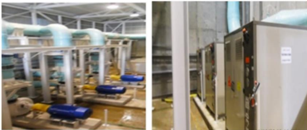
Fig. II.15. Les pompes de lavage et les soufflantes.[05]
