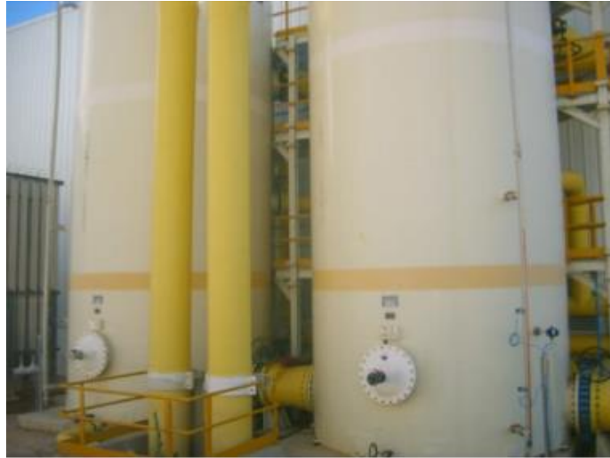
Fig. II.26. Réservoir pour le nettoyage chimique. [05]
