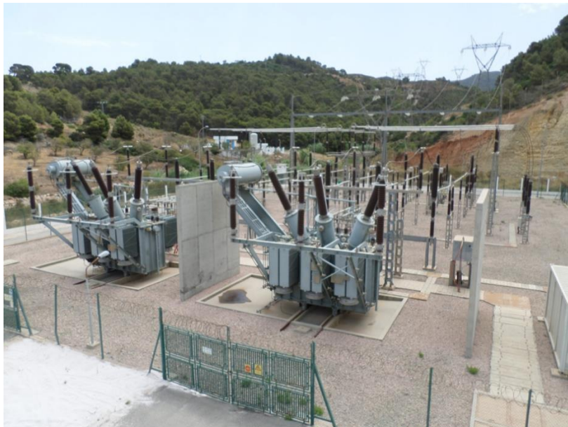
Fig. II.31. Vue de la sous-station électrique. [05]
