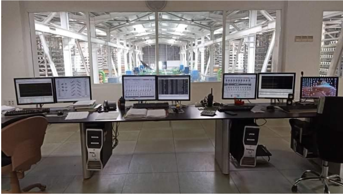
Fig. III.18. Vue de la salle de supervision et de contrôle (Honaine). [05]
