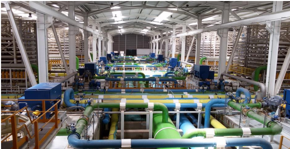
Fig. II.19. Vue de la zone d'osmose inverse.[05]
