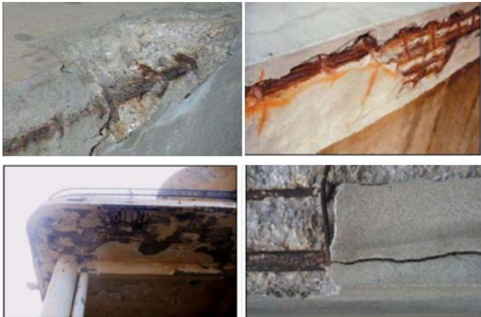
Fig.III-1 : Exemple de corrosion par carbonatation. [15]
