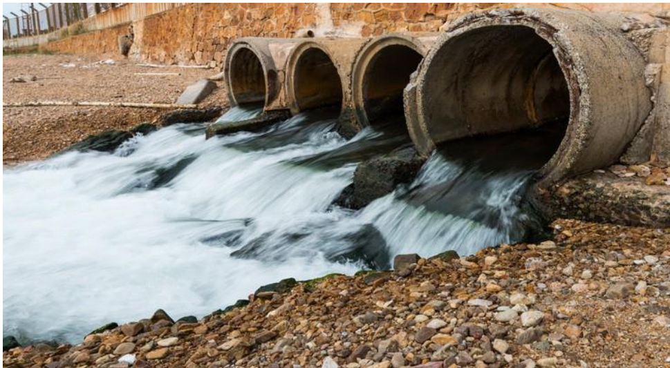
Figure I.4 : Un exemple d'un rejet des eaux usées dans un milieu récepteur
