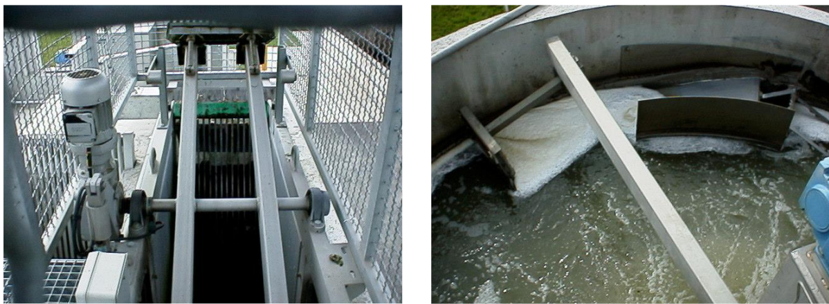
Figure I.8 : Dégrilleur et Déshuilage
