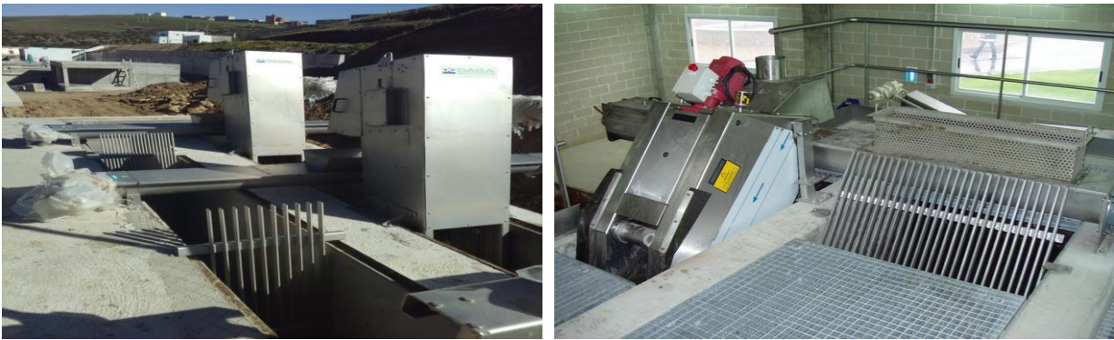
Figure IV.3 : Les dégrilleur grossier et fin
