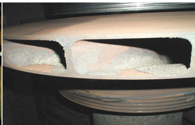
Fig. IV.14: Dépôt de boue sèche à l'intérieur des aubes
