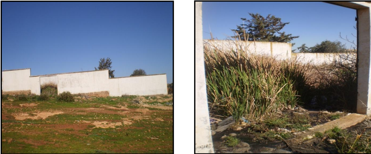
Figure I.19 Bassin de décantation d'Ain-Larbaa
