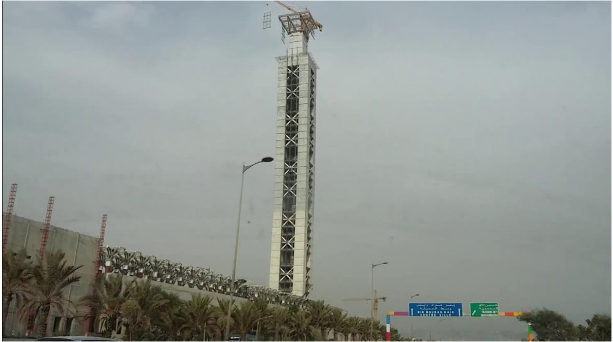
Figure V-6 : contreventement mixte : voiles en béton armé avec des éléments diagonaux en charpente métallique sur les façades.
