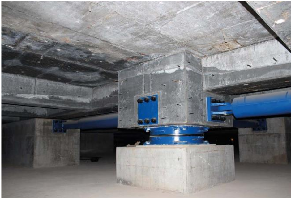
Figure IV-14: Isolateur parasismique de la salle de prière de la grande mosquée d'Alger.
