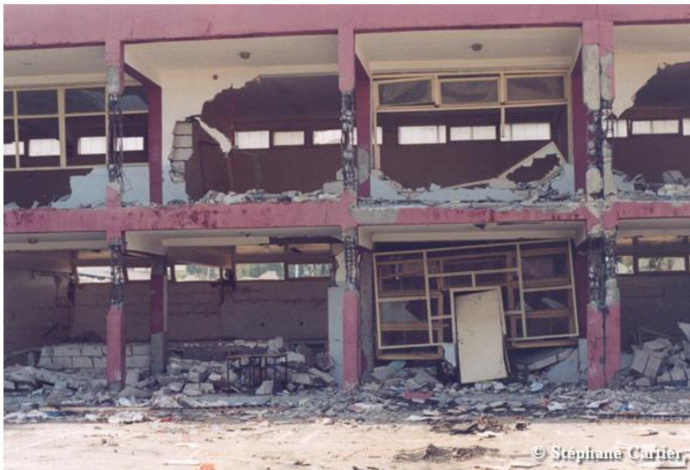
Figure I-17 : École touchée par le séisme du 21 mai 2003, région de Boumerdès, Algérie.
