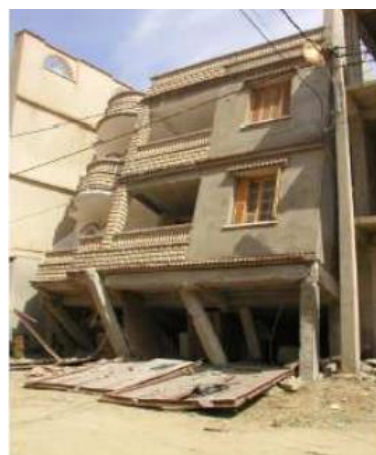
Figure I-2 : Séisme de Boumerdes, Algérie, 2003 .
