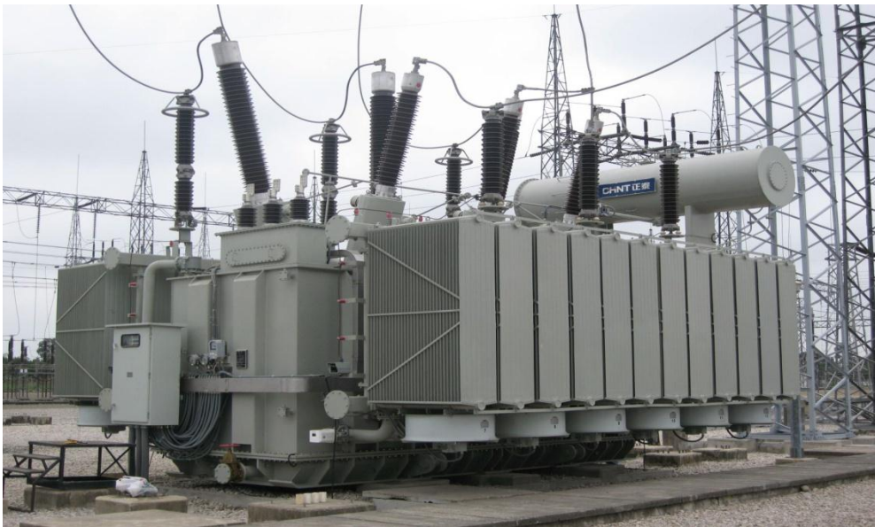
Figure I.1 : Transformateur de puissance
