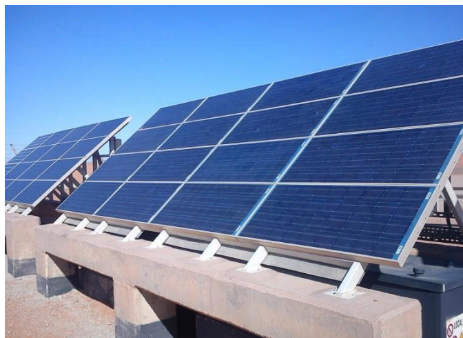
Figure 2.2 : Panneaux solaire de type BP-Solar 375,
