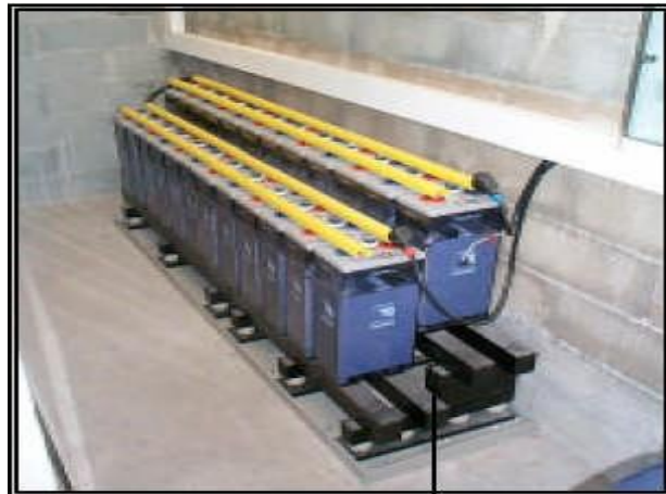
Figure 2.3 : Banc des batteries de type NI-Cd [13]
