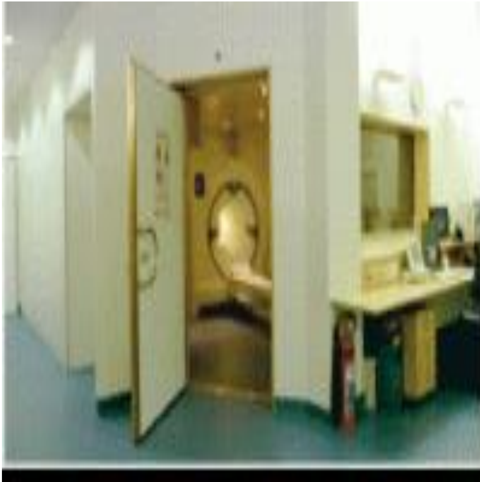
Figure (I-17) : Installation d'un blindage HF (cage de Faraday) pour la salle d'examen.
