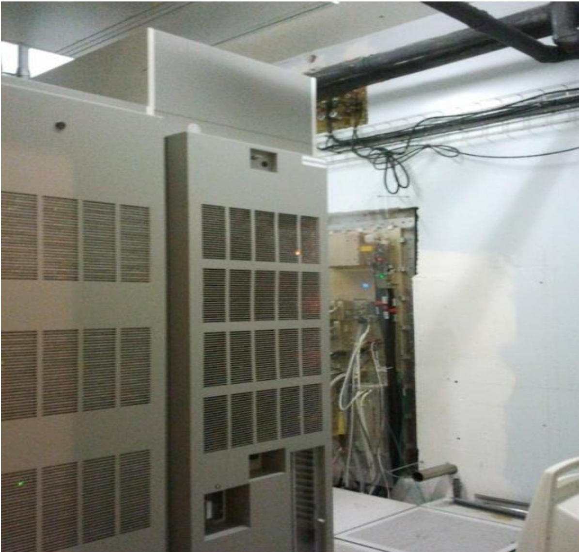
Figure (I-16) : salle de technique
