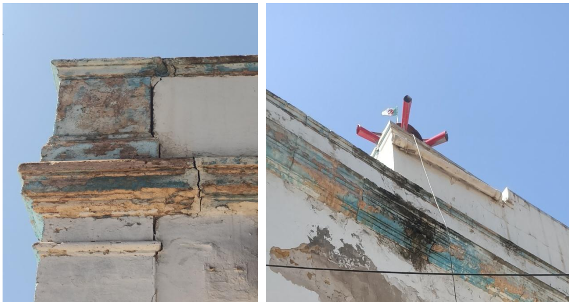
Figure III.25 : Détérioration des toitures et les corniches Source : Auteurs du mémoire
