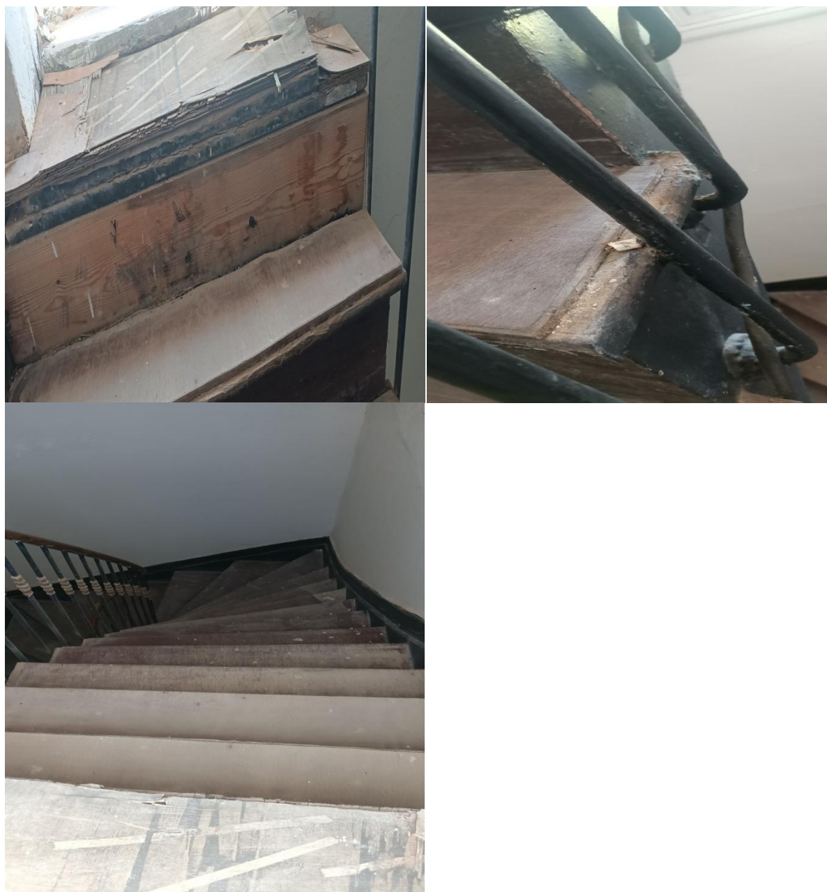
Figure III.34 : Dégradation du bois des escaliers Source : Auteurs du mémoire
