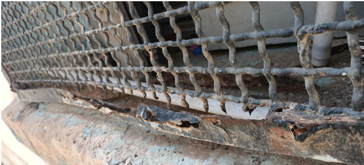
Figure III.35 : Corrosion des fenêtres métallique
