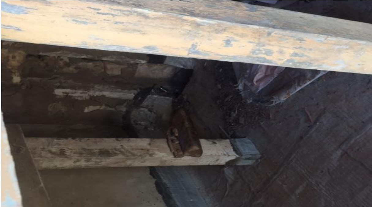
Figure III.36 : Dégradation du bois de la charpente Source : Auteurs du mémoire
