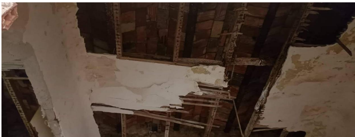
Figure III.27 : Dégradation du plancher
