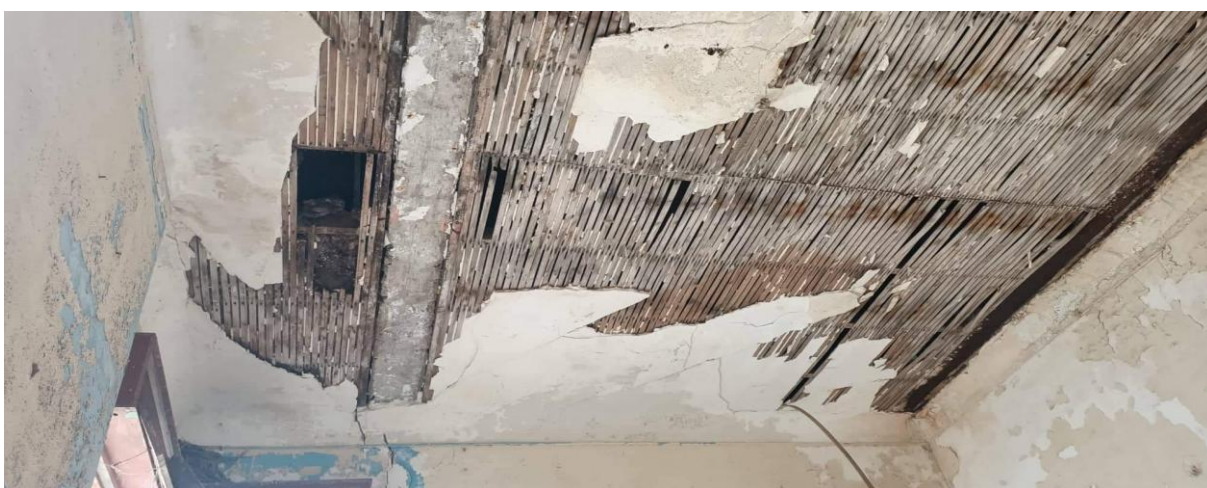
Figure III.28 : Dégradation du plancher
