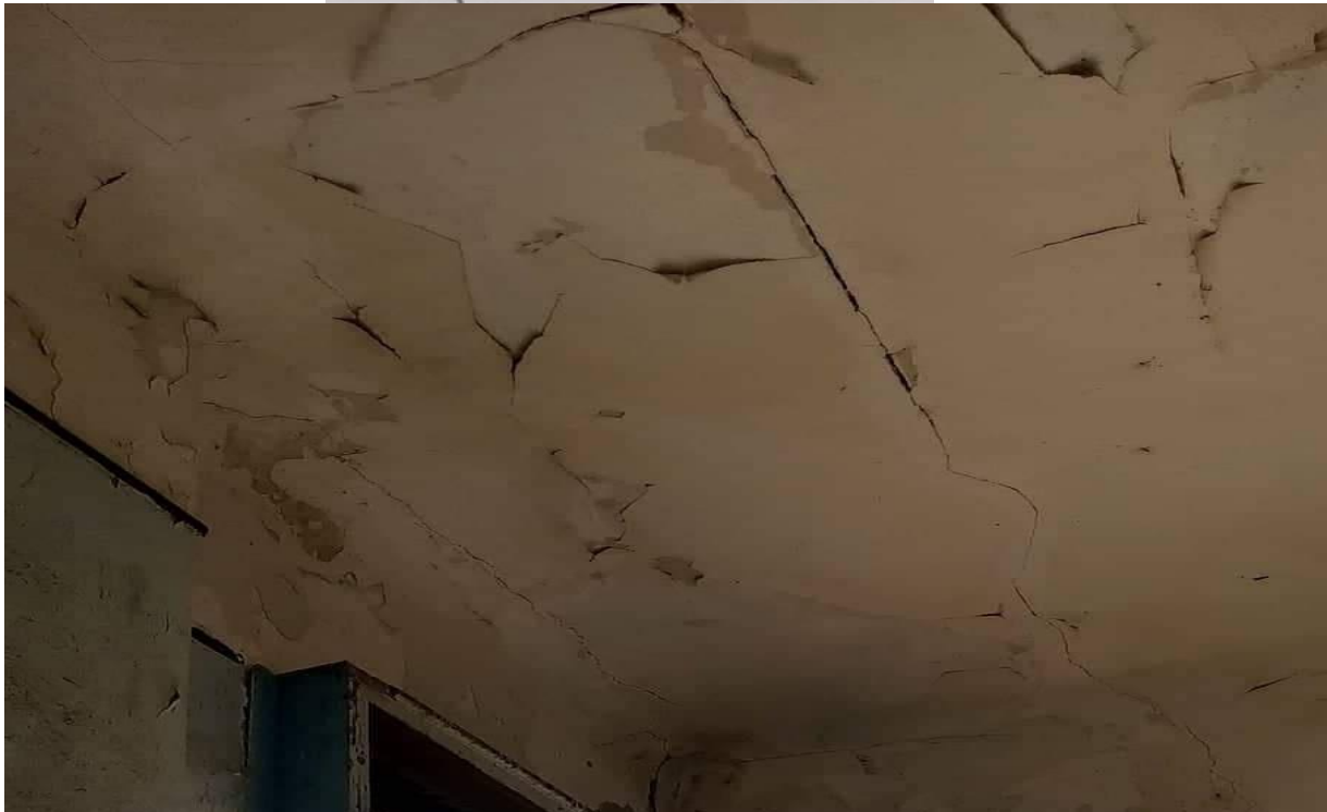
Figure III.32 : Fissures extérieures et intérieures sur les murs
