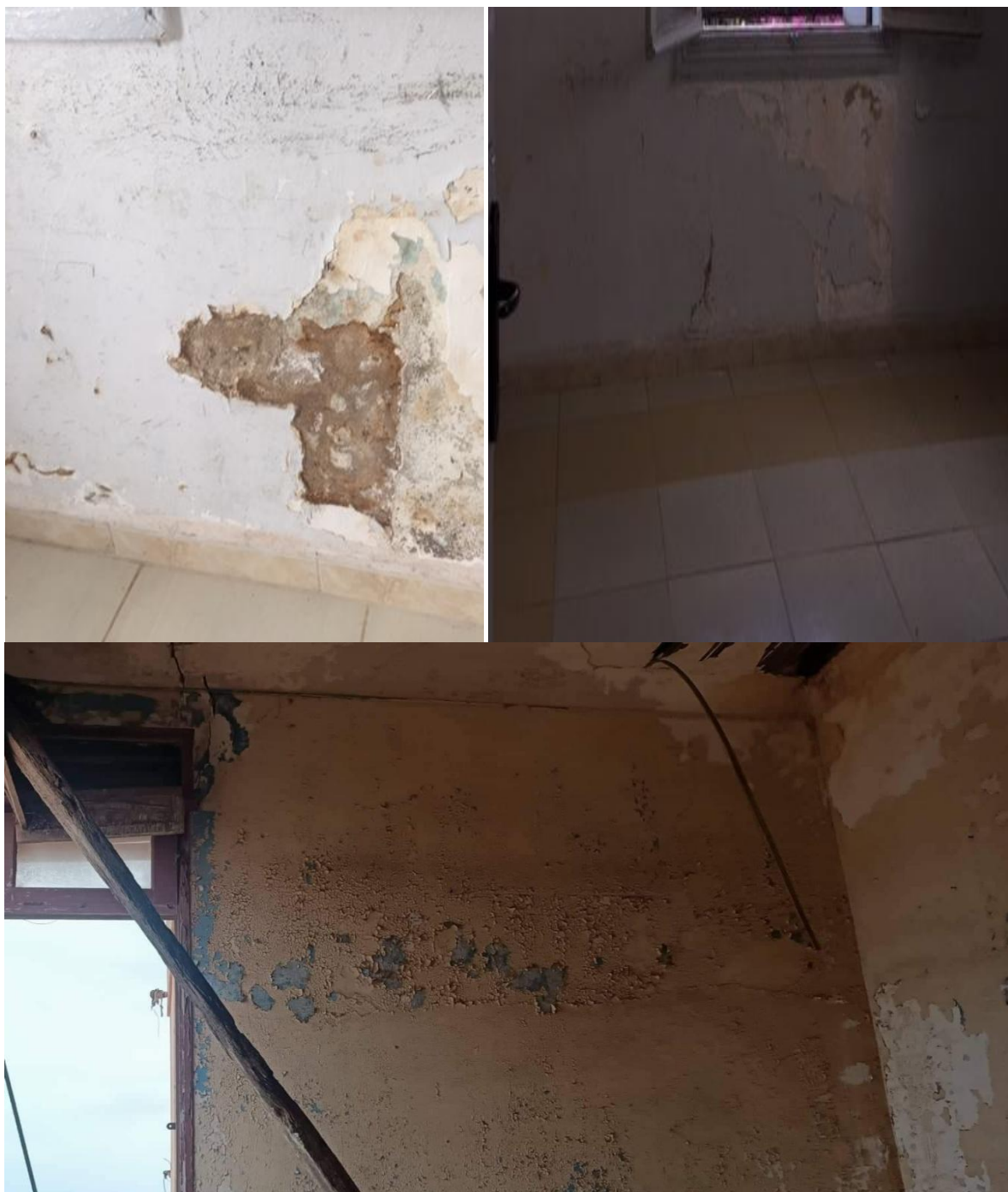
Figure III.39 : Dégradation de la peinture intérieure des murs Source : Auteurs du mémoire
