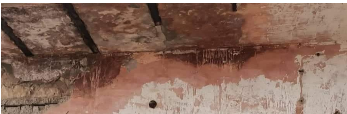
Figure III.29 : corrosion des profilés métallique du plancher voutains
