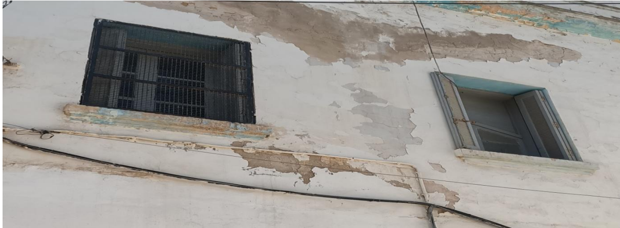
Figure III.40 : Dégradation de la peinture extérieure des murs
