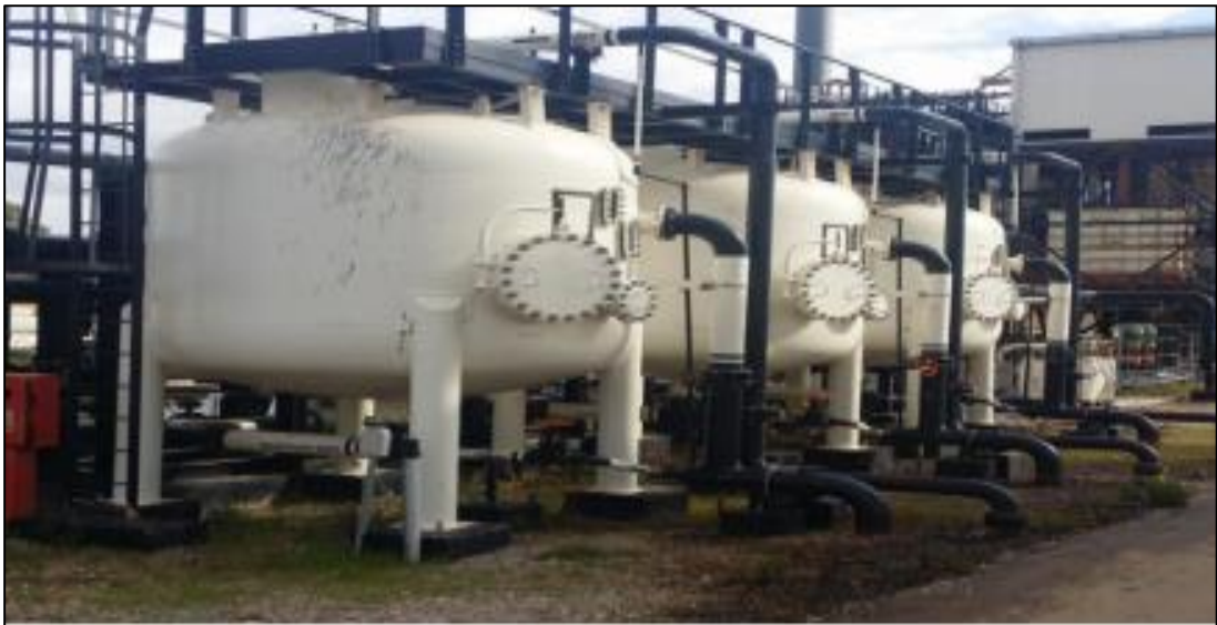
Figure III.19 : Les filtres à trois couches (27K-07 A/B/C).
