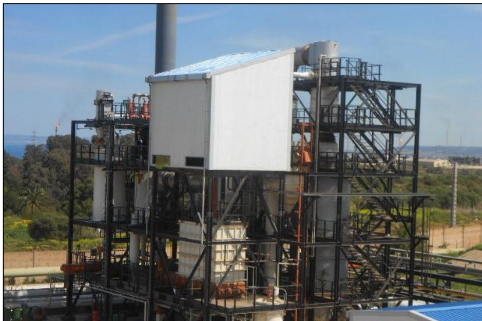
Figure III.24 : Incinérateur de boue.
