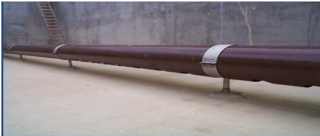
Figure III.11 : Manifold collecteur de boue.
