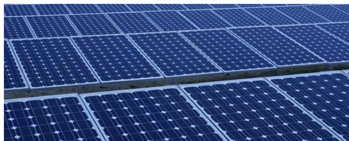
Figure I.2 : panneau solaire photovoltaïque
