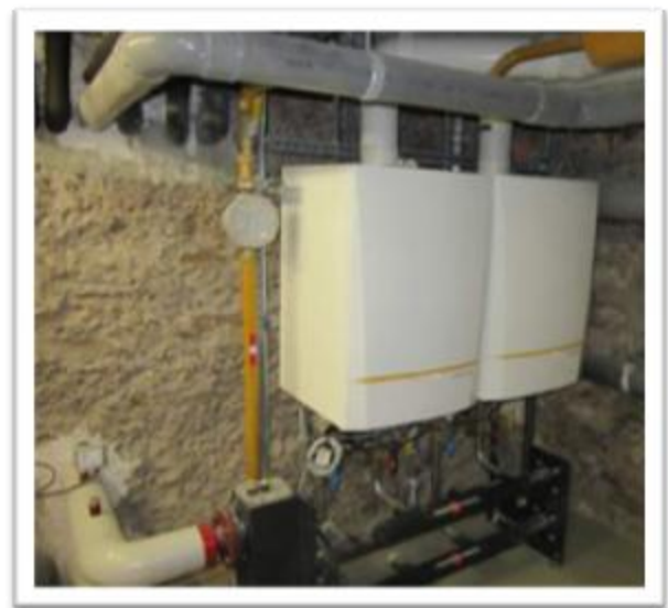
Figure 3-17: Chaudières à condensation gaz en sous-sol
