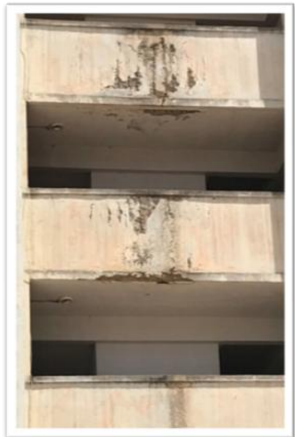
Photo 4-3: Décollement par plaques des enduits
