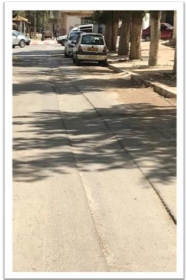
Photo 4-10: les travaux non bien sur La voie de derrière
