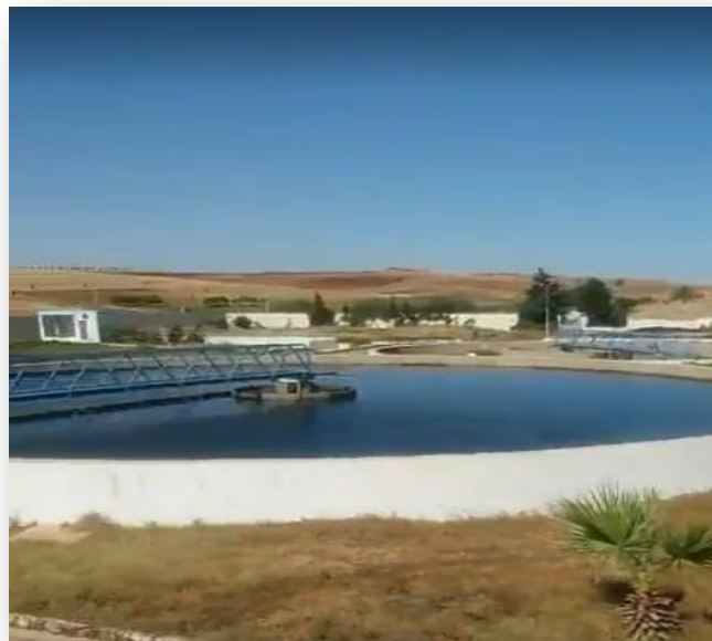
Figure 22 : décanteur secondaire ( BENBOUCHTA.F.UATBB ,2021 )
