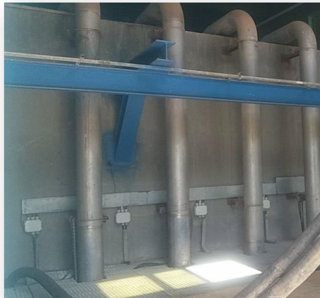
Figure 19 : poste de relevage
