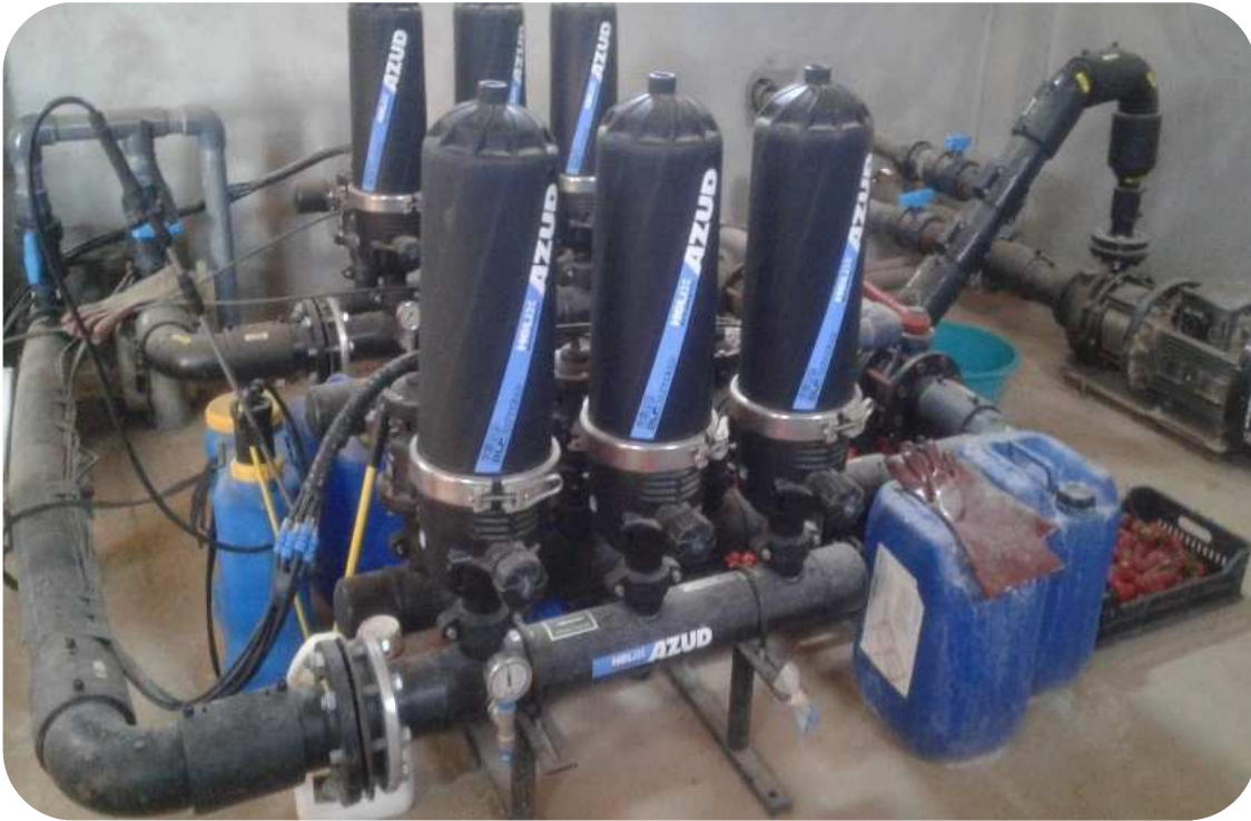
Figure28 : filtres à sable
