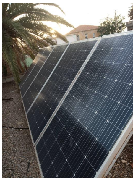
Figure IV-1 installation photovoltaïque de l'école REZIGUI Boucif
