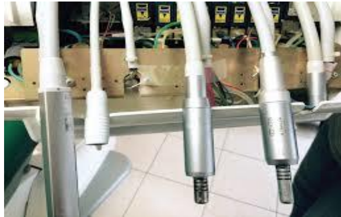
Figure 2 : Les tubulures d'eau des unités dentaires
