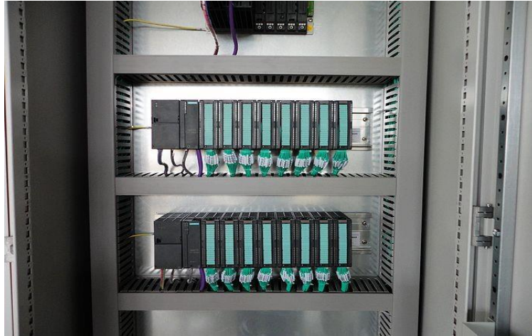
Figure II-2 : Exemple d'une armoire d'Api [W13]
