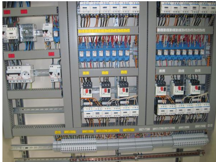
Figure II-1 : Exemple d'une armoire électrique (logique câblée) [W12]
